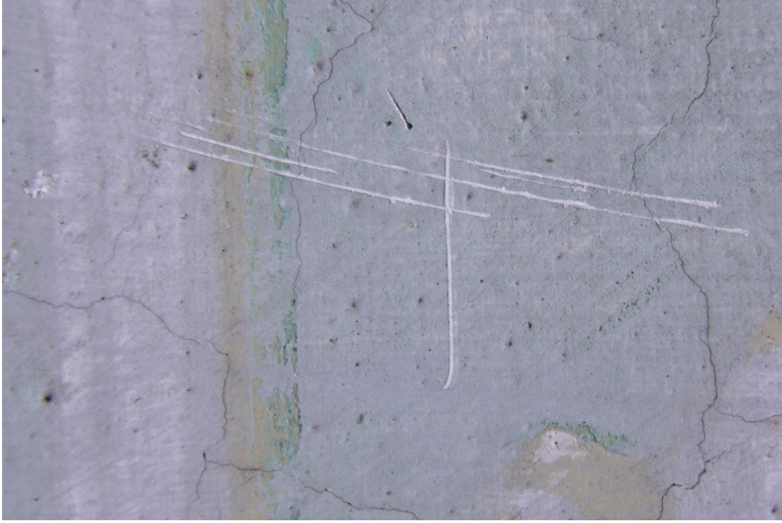
Obr.30: Mechanické defekty v originální barevné vrstvě. Stav před restaurováním.
