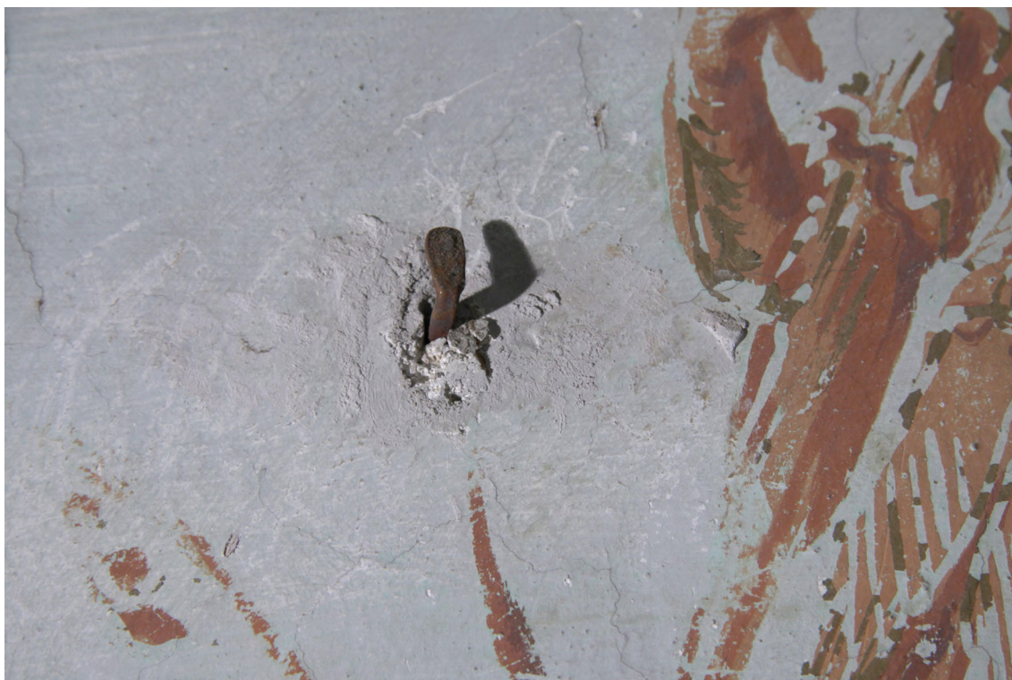
Obr.27: Dodatečně přidaná skoba, zatmelena sádrovým tmelem šedé barvy. V okolí tmelu lze pozorovat škrábance zasahující až do vápenného nátěru. Stav před restaurováním.
