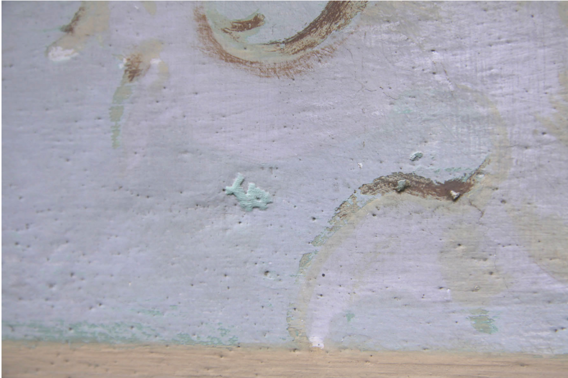
Obr.29: Zde lze pozorovat originální defekt v podkladovém nátěru, kde se dochoval fragment původní barevnosti zeleného pozadí. Stav před restaurováním.
