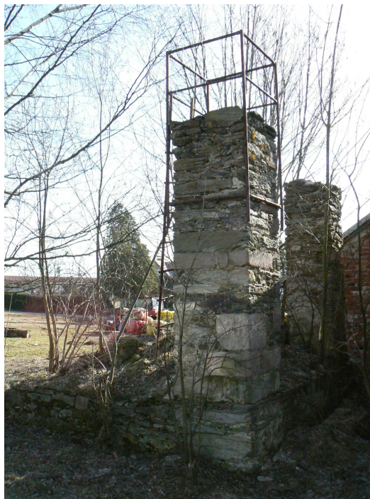
Příloha č. 33: V 90. letech 20. století byla zbořena i farní stodola. Jako memento z celého farního areálu tak přečkaly pouze tyto dva její čelní pilíře. Současný stav.
