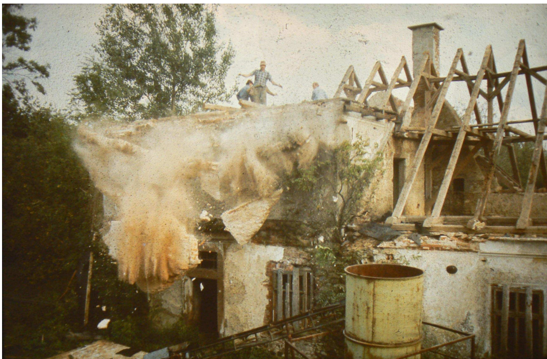
Příloha č. 30. Na této fotografii z demolice farní budovy v roce 1984 je zachycena její přední část směrem k návsi. Levé křídlo bylo zbořeno již v padesátých letech.
