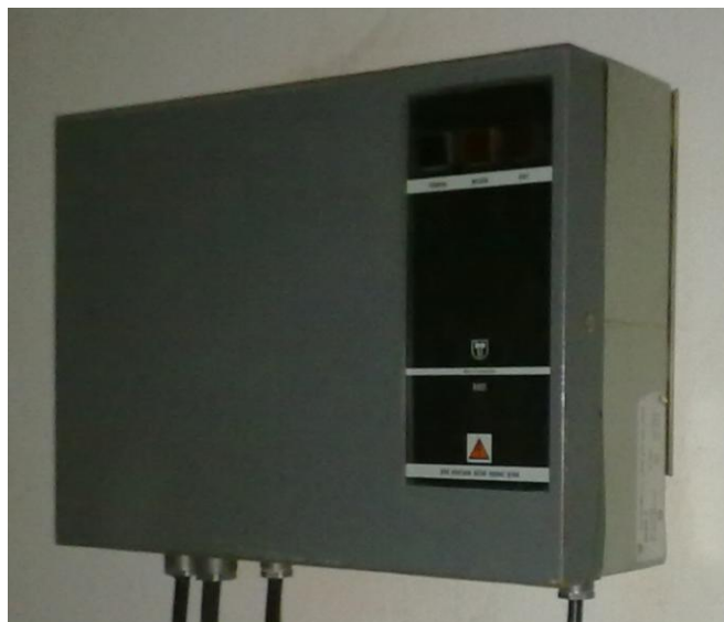
Obrázek 21: Rozvaděč hořáku ZPA AHDI 3
