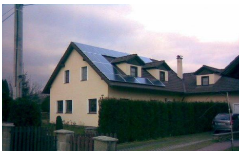
Obrázek 9: Fotovoltaický systém značky Solarwatt - 18 solárních panelů na střeše domu
