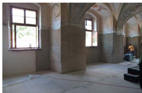
obr. 18 Vnější západní stěna, na níž jsou nanesené zkušební zábaly
