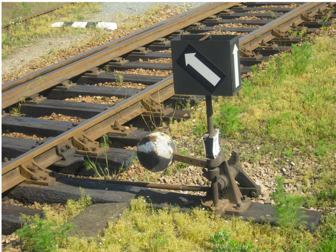
Fotodokumentace 20 - Mechanické ovládání výhybky
