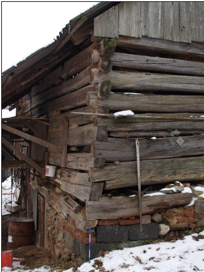
Obr. 4 – rybinové spoje a horní věnec na nároží přední a pravé příčné stěny
