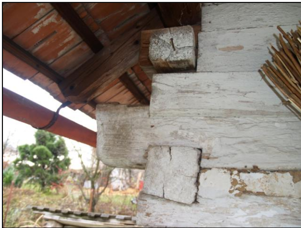
Obr. 4 - příčný trám horního věnce s dlabem po odstranění okapové vaznici
