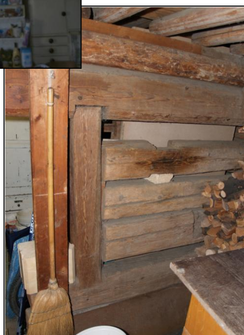
Obr. 9 – otvor v perně stodůlky ohraničený stojkou, do které jsou trámy zapuštěny na pero a drážku
