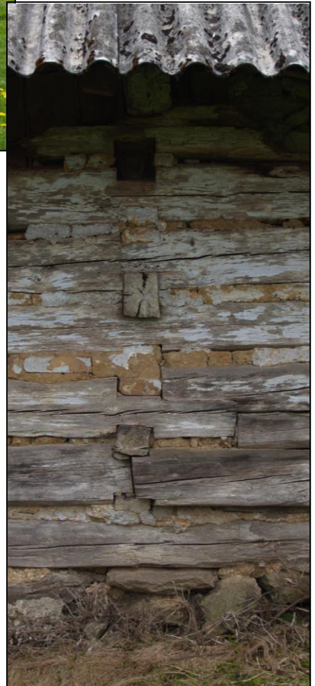
Obr. 6 – zaroubení trámů přezděné příčky mezi světničkou a černou kuchyní
