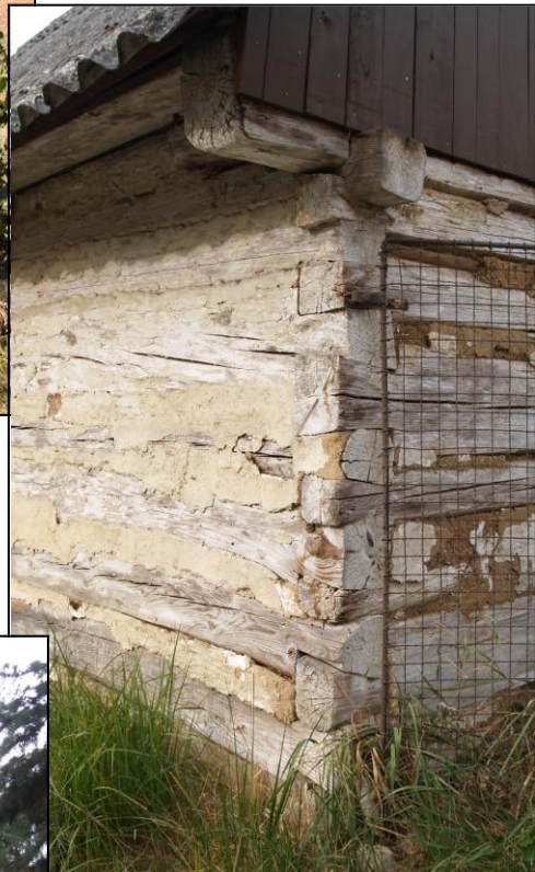
Obr. 2 – Rybinové spoje a horní věnec na nároží zadní a levé příčné stěny
