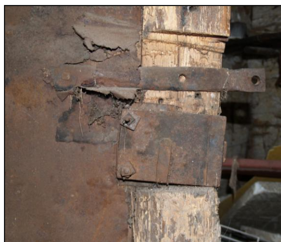
Petroupim čp. 21 – železný pás na rubu dveří se závitem, do kterého se šroubuje šroub umístěný ve stojce.
