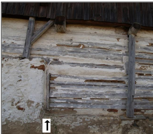
Obr. 3 – ukončení roubení do stojky na pero a drážku před vystupujícím tělesem pece (viz. šipka)
