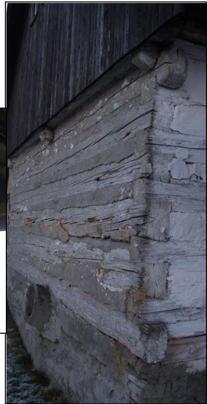
Obr. 4 – Rybinové spoje na nároží pravé příčné a zadní stěny. Z příčné stěny nahoře vystupují stropní trámy, které vynášejí nefunkční okapovou vaznici.
