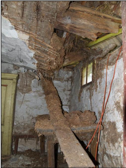
Obr. 13 – propadlý strop u zadní stěny č. kuchyně
