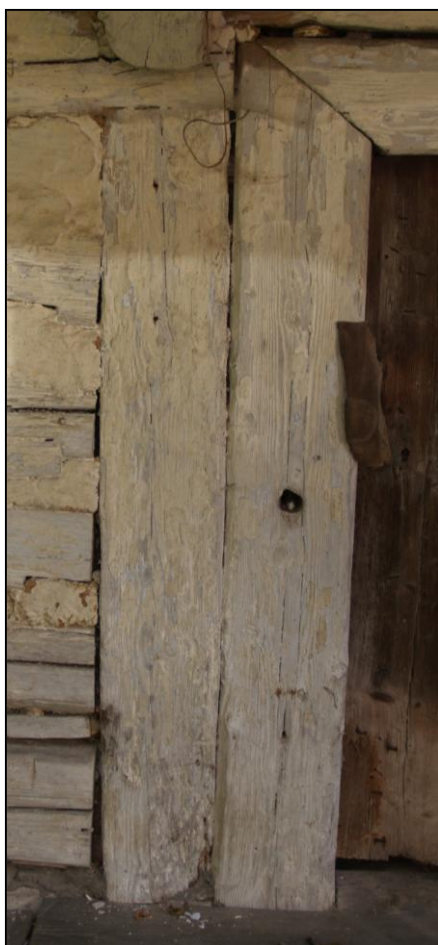
Křešice čp. 2 – otvor se šroubem v levé stojce portálu
