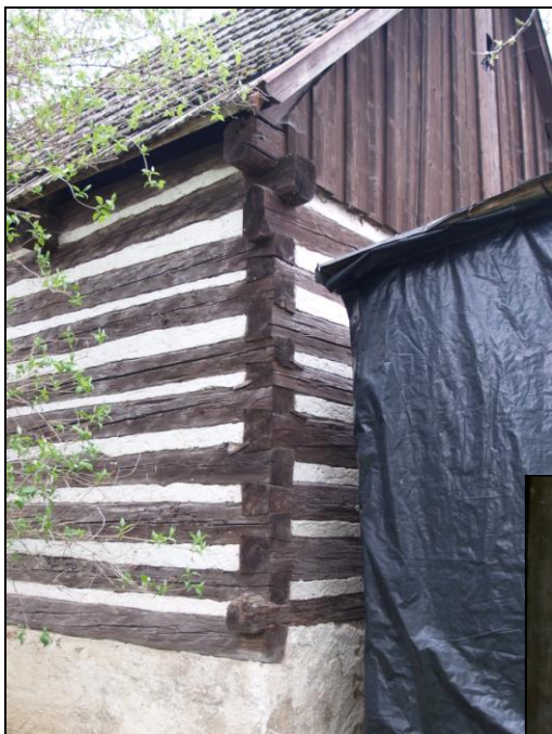
Obr. 3 – rybinové spoje a horní a dolní věnec nároží zadní a pravé příčné stěny
