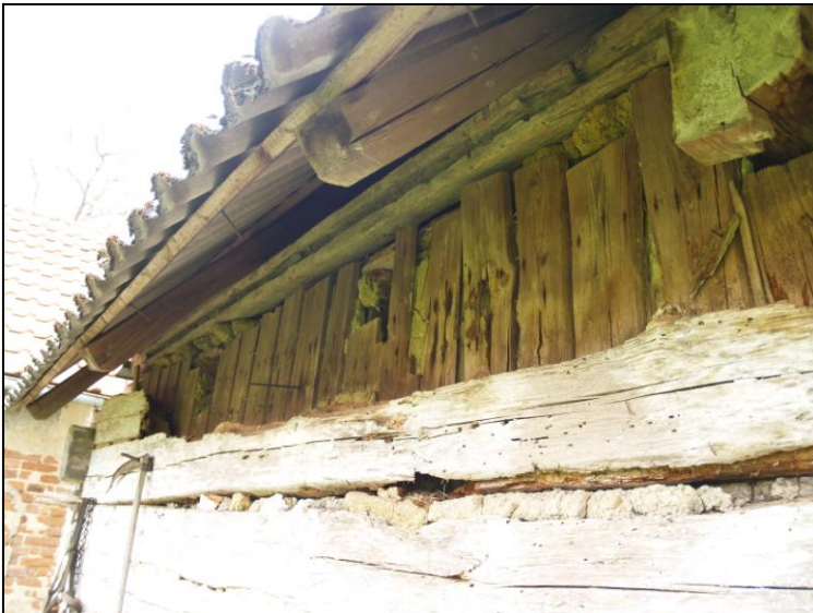
Obr. 9 – uhnílý trám vrchní vrstvy roubení zadní stěny, za nímž jsou prkna, na která je nanášena lepenice. Okapová vaznice je z druhotně užitého trámu s drážkou.
