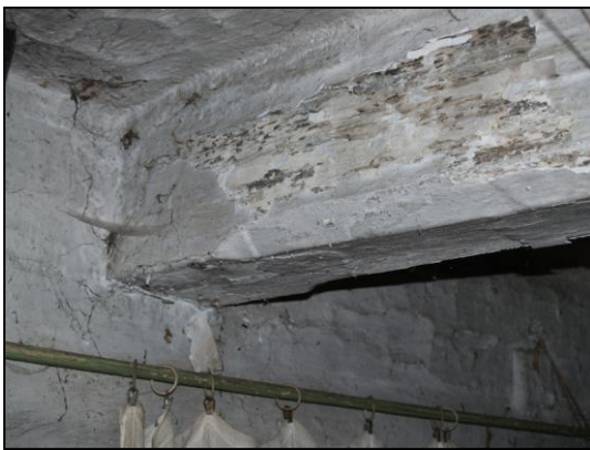
Obr. 11 – okosení stropního trámu ve světnici
