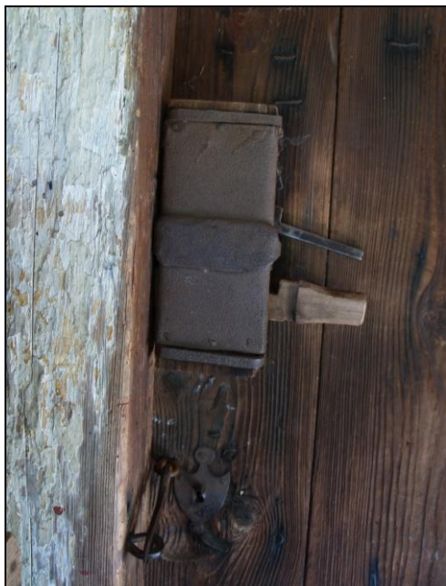
Obr. 5 – oplechovaný dřevěný zámek
