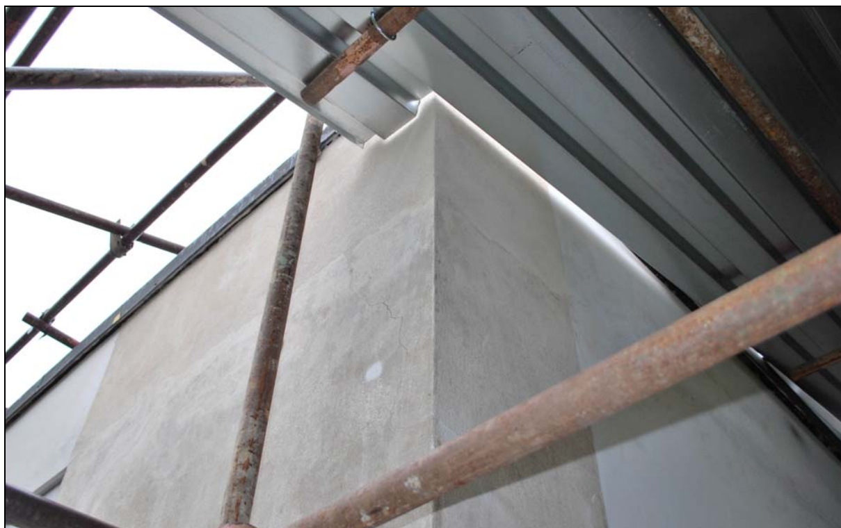
Foto č. 35: Horní terasa, jihovýchodní nároží pokoje Grety, situace během tmelení trhlin.
