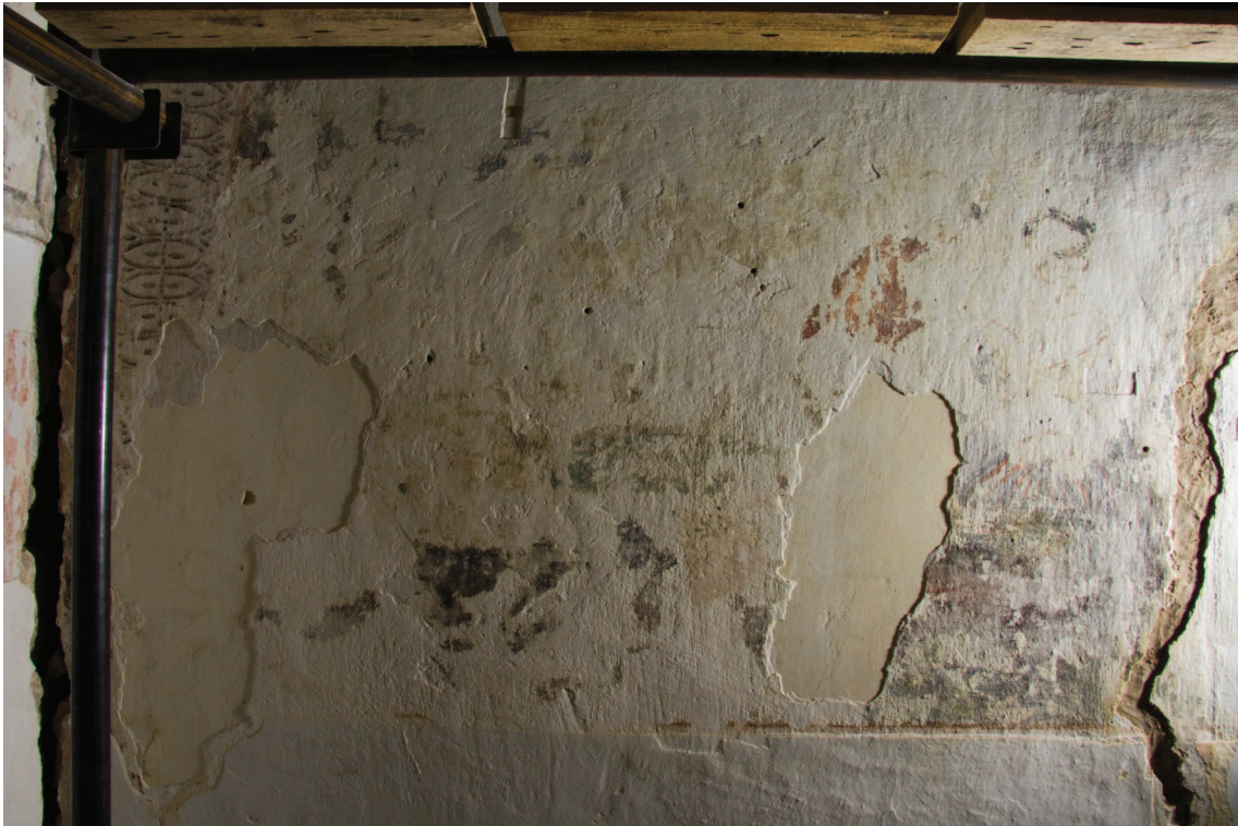
Obr. 40: Spodní část vymezeného dílu, stav po odkryvu. Foto v ostrém boční světle, celkový pohled.
