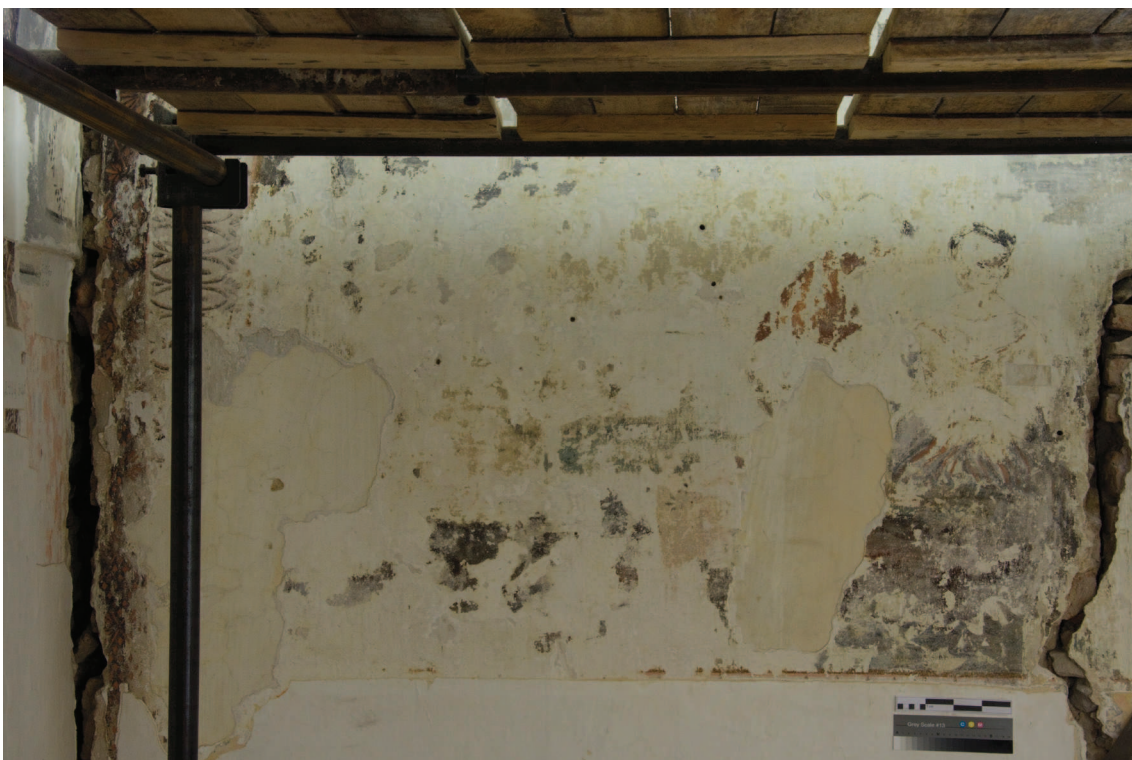
Obr. 36: Spodní část vymezeného dílu v levé části východní stěny. Stav po odkryvu a odstranění nevhodných vysrávek a tmelů, celkový pohled, foto v rozptýleném světle.
