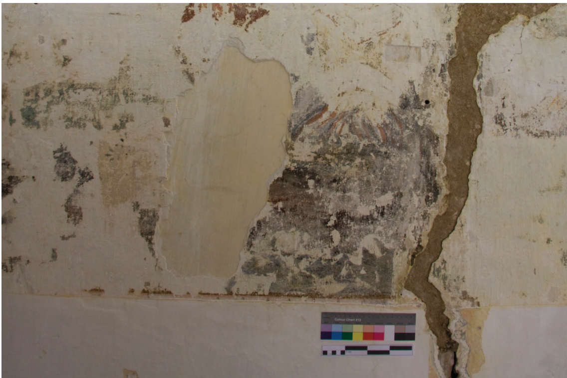
Obr. 12: Totéž místo, stav po odkryvu. Pod odchlupujícími se krakely nátěrových vrstev byla dochována barevná vrstva, která byla ve většině míst rovněž oddělená od podkladu. Stav po odkryvu s použitím koncentrované akrylátové disperze Primal SF016 ředěné 1:1 s vodou. V okolních částech je barevná vrstva zachována pouze v malých fragmentech.
