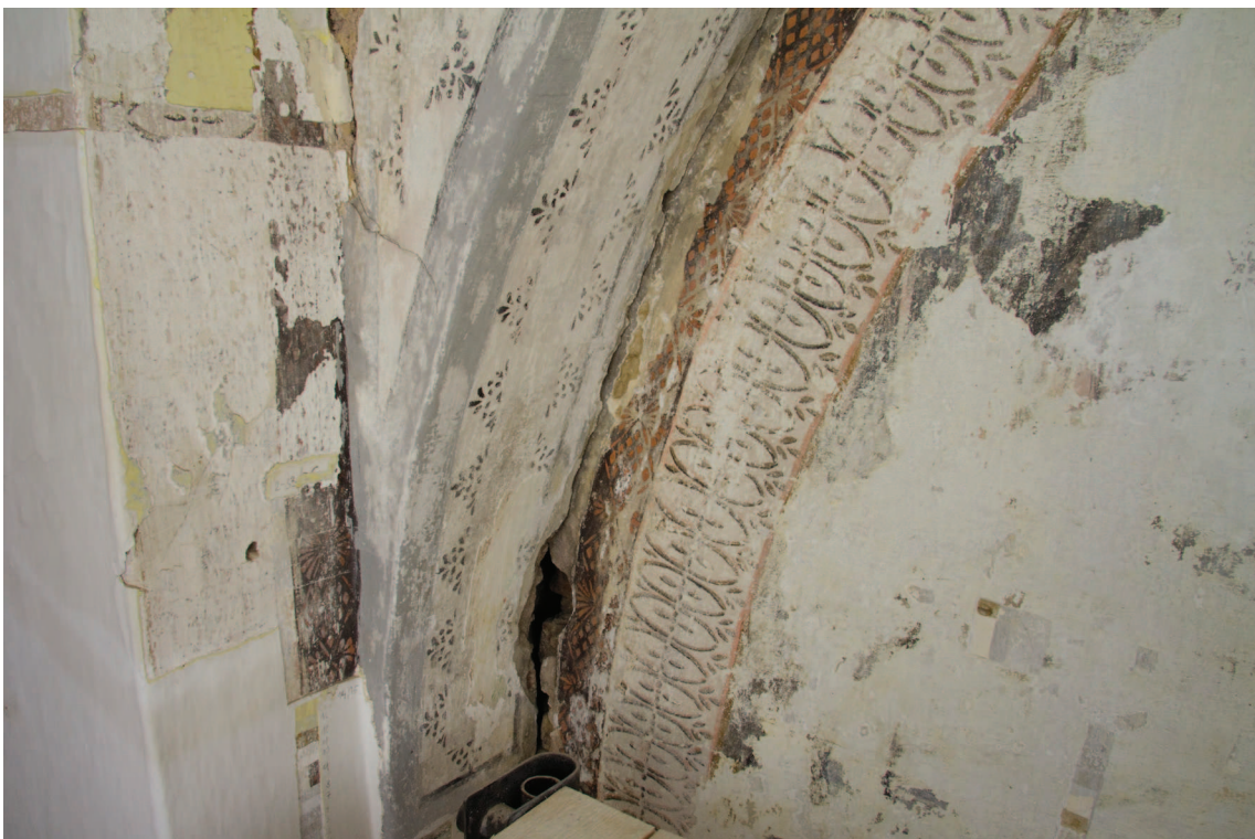
Obr. 35: Detail praskliny v levém rohu mezi východní stěnou a náběhem klenby.
