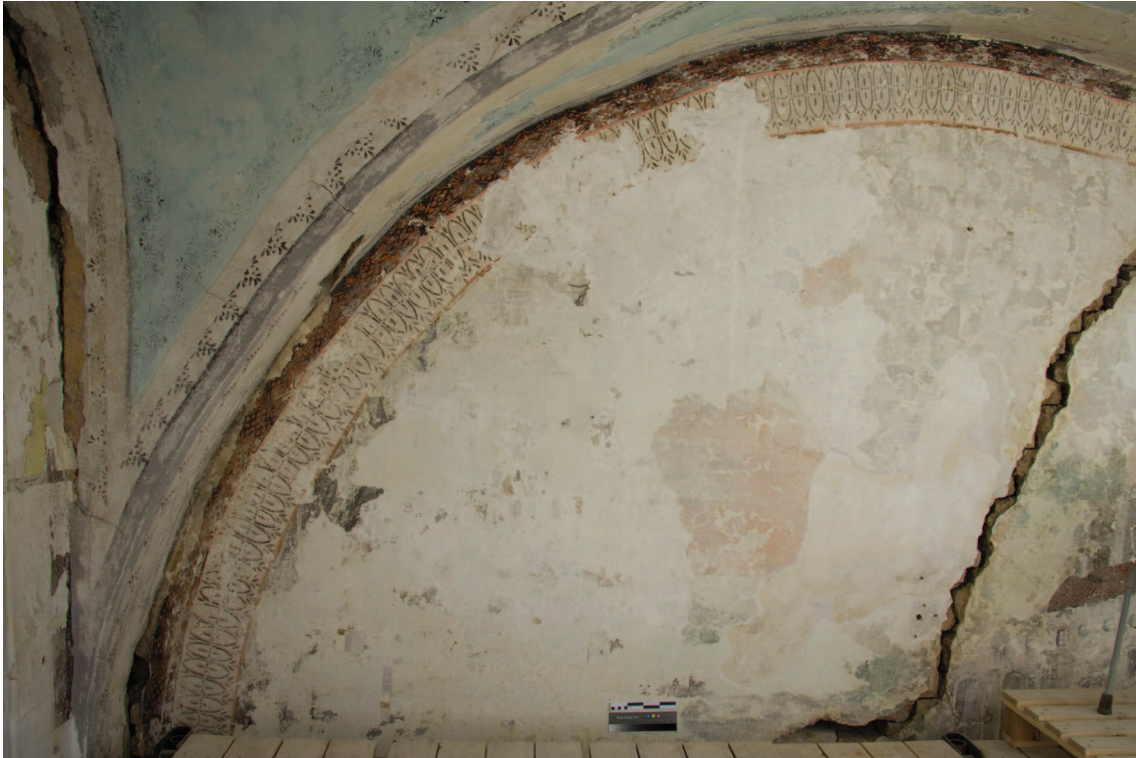
Obr. 34: Horní levá část východní stěny po odkryvu a odstranění nevhodných vysprávek a tmelů. Celkový pohled, foto v rozptýleném světle.
