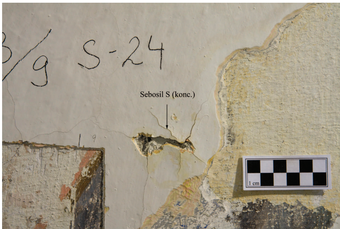
Obr. 29: Detail nevhodného použití konsolidantu na bázi oxidu křemičitého Sebosil S na upevnění odchlípnutých krakel překryvných nátěrových vrstev včetně vrstvy malby. Sebosil S byl aplikován s vápennou vodou pod zvednuté krakely, ty byly přitlačeny k podkladu a místo bylo přelepeno japonským papírem. Při vysychání však docházelo k velké kontrakci a po vyschnutí byly krakely nátěrových vrstev ještě více odchlípnuté. Místo bylo velice pevné a křehké, krakely se nedoparilo upevnit zpět.
