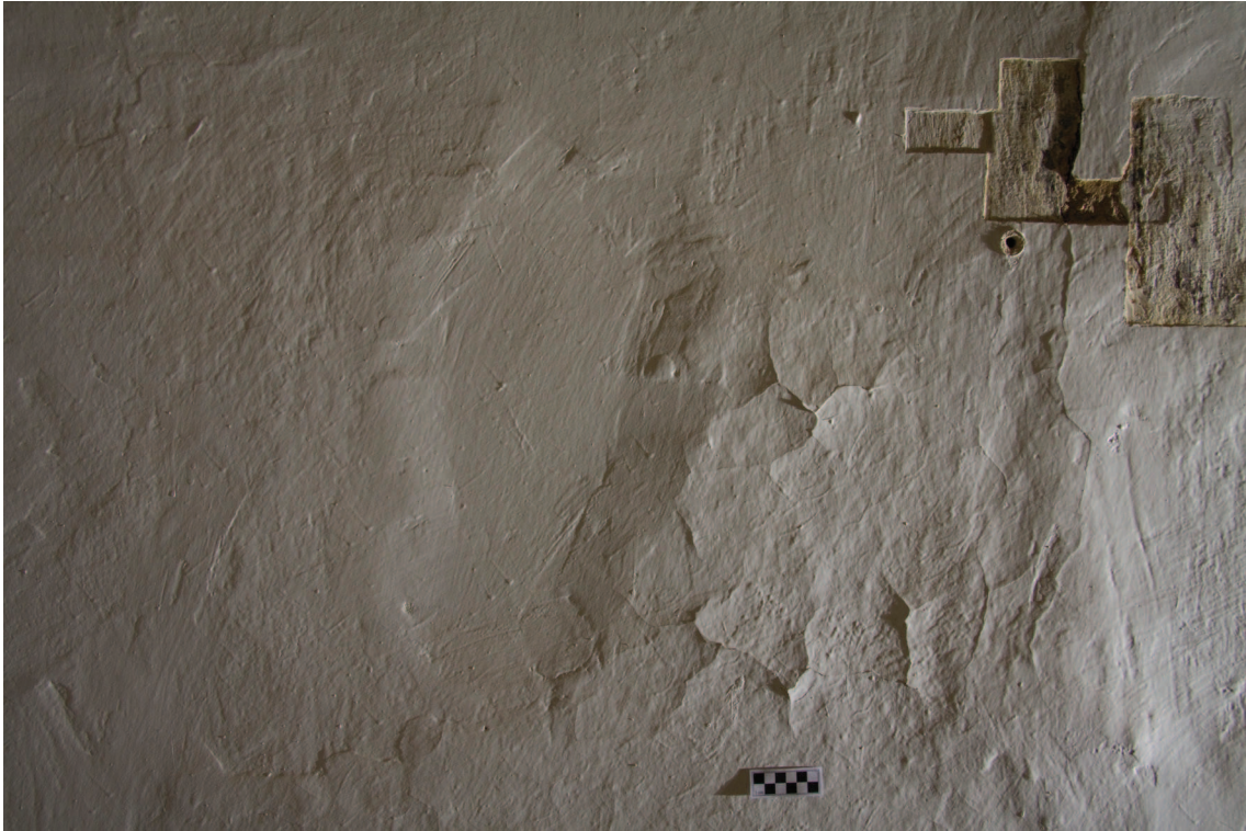
Obr. 11: Stav před restaurováním, detail v ostrém bočním nasvícení. Na reliéfu stěny lze pozorovat propadlé místo, které značí chybějící barevné a podkladové vrstvy. Okraje tohoto defektu byly před zakrytím vytmeleny doztracena. Napravo od defektu jsou patrné miskovitě se odchlupující vrstvy nátěrů.
