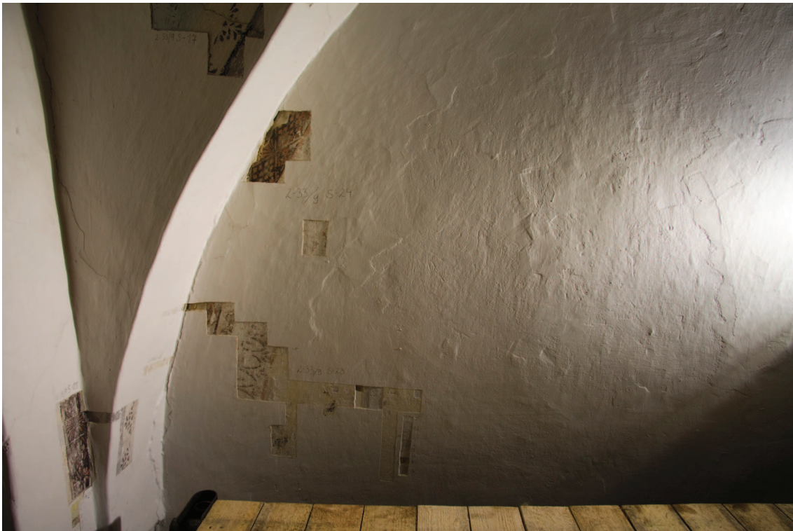
Obr. 9: Stav před restaurováním, foto v ostrém bočním světle. Na povrchu stěny je dobře patrné rozhraní mezi místy, kde jsou pod vrchním bílým nátěrem dochovány všechny vrstvy včetně barevné vrstvy malby, a mezi místy, kde byla stěna před poslední výmalbou starších úprav zbavena. Dole pro srovnání stav po odkryvu.
