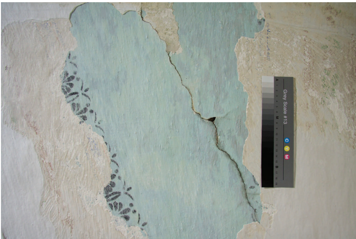
Obr. 31: Detail praskliny a dutiny v podkladových vrstvách na klenbě.
