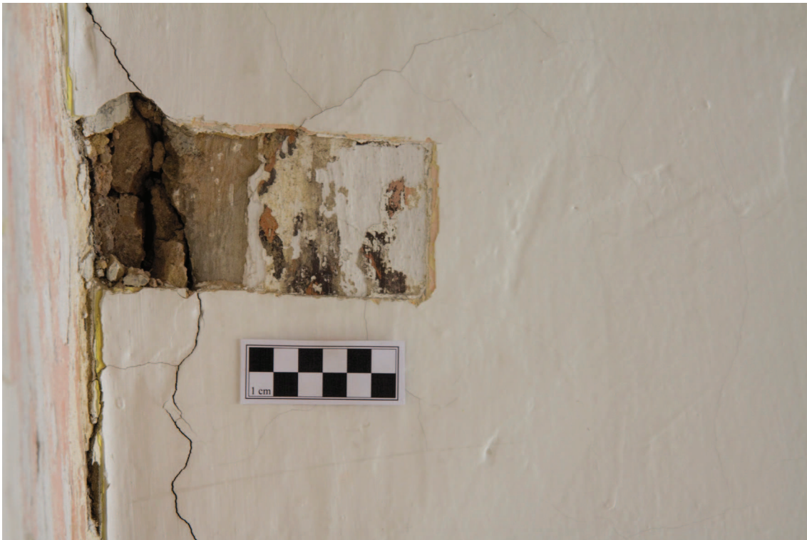
Obr. 7: Detail sondy v levém rohu pocházející ze sondážního průzkumu v roce 2003. V pravé části sondy byl patrně proveden odkryv na vrstvu nástěnné malby, v levé části je odhalena prasklina a nesoudržný tmel.
