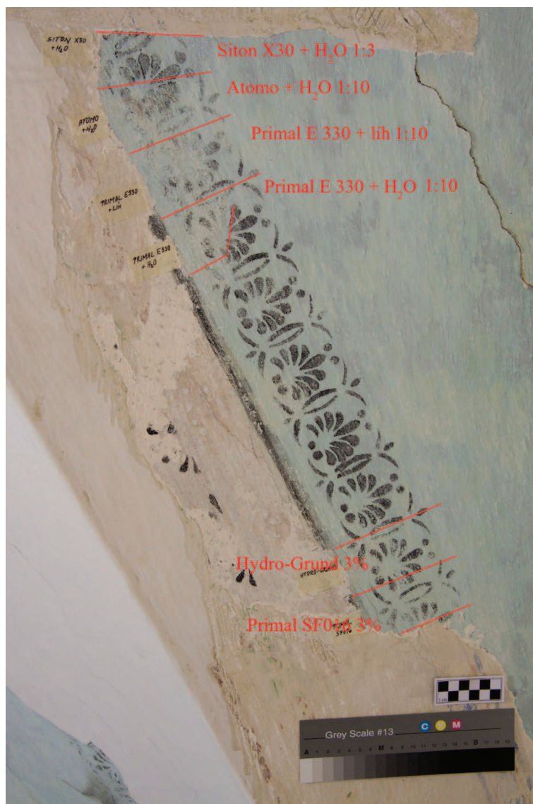
Obr. 26: Zkoušky předzpevnění barevné vrstvy před odkryvem. Konsolidanty byly aplikovány po odstranění vrchních překryvných vrstev až na poslední vrstvu vápenného nátěru nad barevnou vrstvou malby. Přes tuto ztenčenou vápennou vrstvu byly aplikovány konsolidanty natřením štětcem. Zkoušky předzpevnění touto formou vycházejí spíše negativně. Došlo sice ke zpevnění barevné vrstvy, ale zároveň ke zpevnění vrchní překryvné vápenné vrstvy. Lepší výsledek měl odkryv bez předzpevňování (na fotografii uprostřed). Možnosti odkryvu se však velmi lišily místo od místa, proto výsledek zkoušek předzpevnění může být zavádějící. Místa, kde byly zkoušeny konsolidanty, byla problematictější než odkryté místo mezi nimi. Je možné, že bez použití konsolidantů by měl odkryv podobný výsledek. Vyhodnotit tyto zkoušky je proto obtížné.
