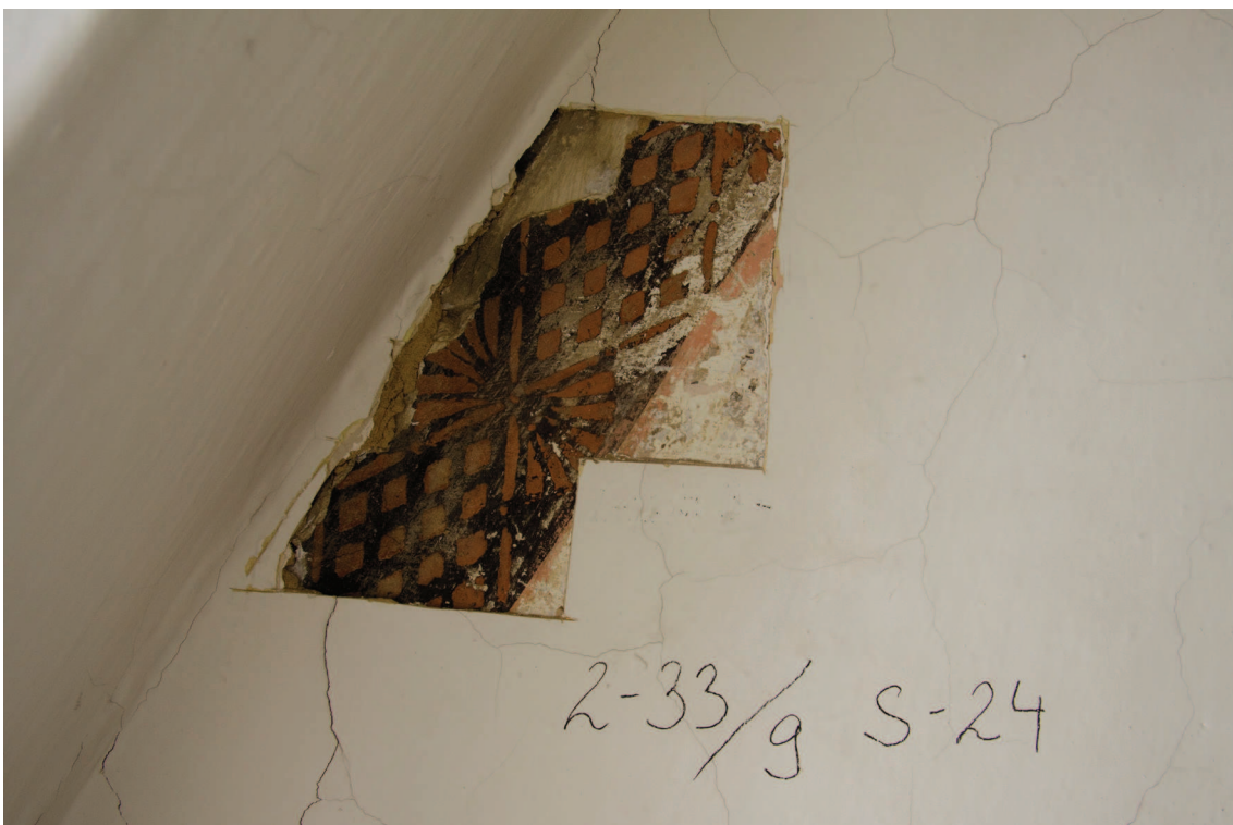
Obr. 8: Detail sondy v levém rohu na styku východní stěny a klenby, sonda pochází z průzkumu v roce 2003. Odkryta devátá vrstva - nástěnná malba. V rohu je patrná prasklina a část sypkého žlutého tmelu.
