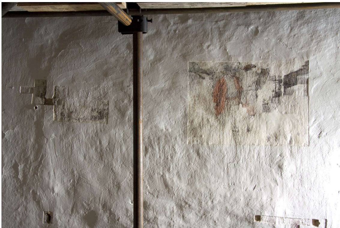
Obr. 13. Razantní (boční) nasvícení spodní části mého úseku na stěně (jeho vrchní poloviny), stav před restaurováním. Čitelná jsou poškození souvrství nátěrů a stěny (zdiva), zde praskliny, uvolnění a zazdívky. Nerovnosti povrchu celého souvrství nátěrů, překrývající malbu určenou k restaurování, kopíruje nerovnosti povrchu odhalené malby.
