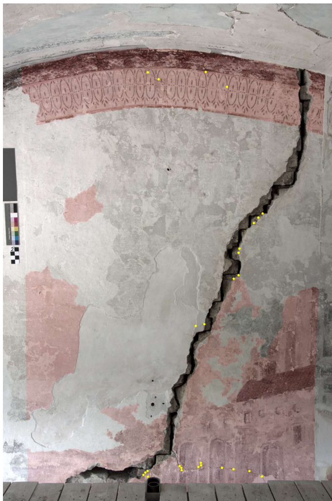
Obr. 52. Vrchní část mého úseku na stěně. Žlutě vyznačená jsou místa hloubkové konsolidace ( Ledan D2 : plavená křída 2:1). Červeně tónovány jsou místa plošné fixáže zprašující se malby ( Primal WS24 3% v lihu, 1-2x). Lokální konsolidace malby není značená vzhledem k tomu, že během odkryvu byla většina míst kde je malba dochovaná konsolidována.
