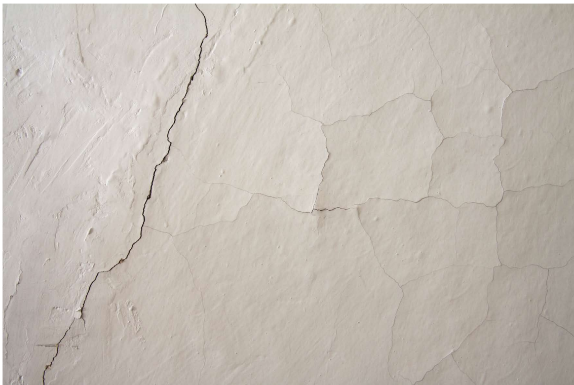
Obr. 23. Na stěně byla lokálně identifikována rozsáhlá uvolnění celého souvrství nátěrů, která vytvářela síťové krakely, zvednuté od podkladu až o několik milimetrů, při doteku pohyblivé. Stav před restaurováním.
