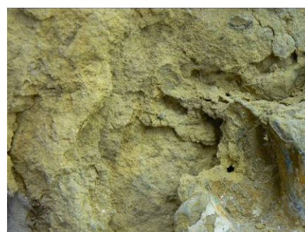
Obr. 2 Ukázka degradace zápského pískovce
