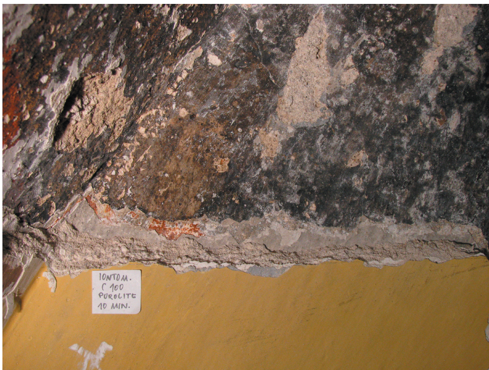
Obr. 49. Východní stěna. Zkoušky čištění ztmavlé barevné vrstvy.
