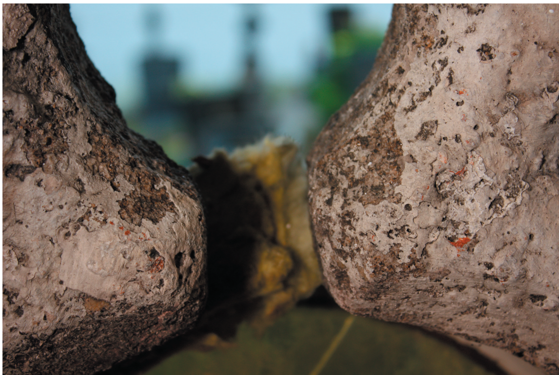
Obr. 45. Žulová kružba gotického okna s fragmenty vápenných nátěrů. Foto: M. Třesohlavá.
