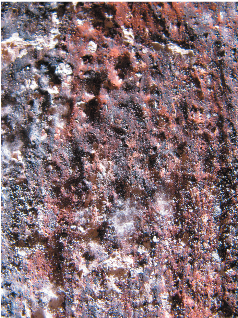
Obr. 17. Nejstarší identifikovaná středověká (románská) omítka na východní stěně. V nálezů z jedné časové vrstvy jsou čitelné dva typy použité malty.
