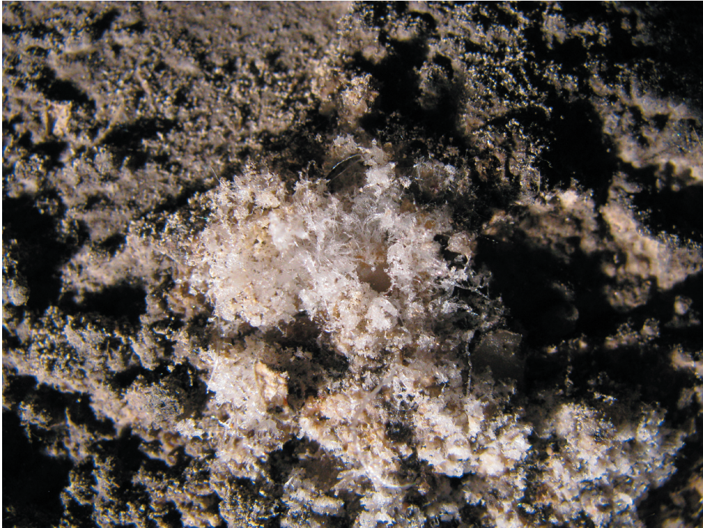
Obr. 29. Výkvěty solí na povrchu omítek. Detailní záběr.
