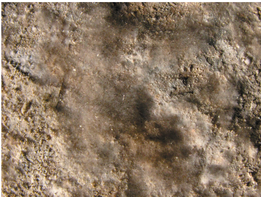
Obr. 26. Masivní výskyt plísní na východní stěně (barokní omítka).
