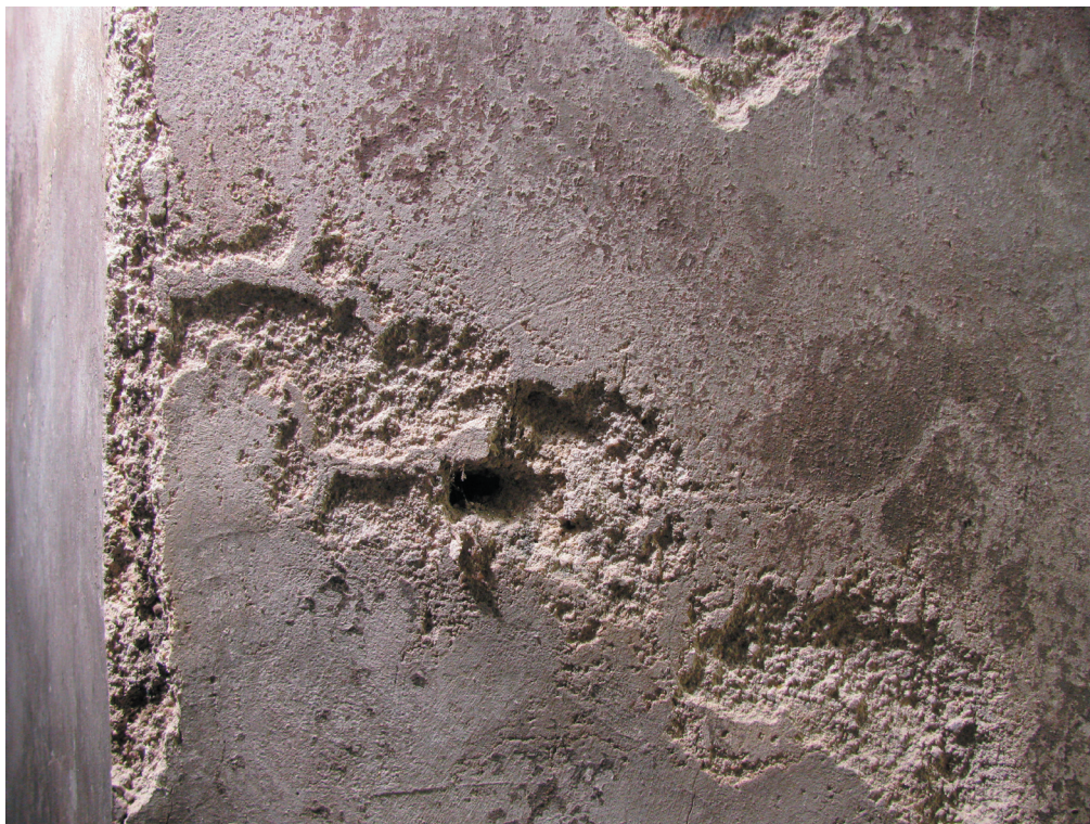
Obr. 28. Levá strana okenní špalety (korodovaný povrch barokní omítky). Účinky působení vodorozpustných solí.
