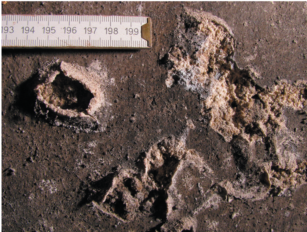
Obr. 27. Východní stěna (ztmavlý povrch barokní omítky). Účinky působení vodorozpustných solí.
