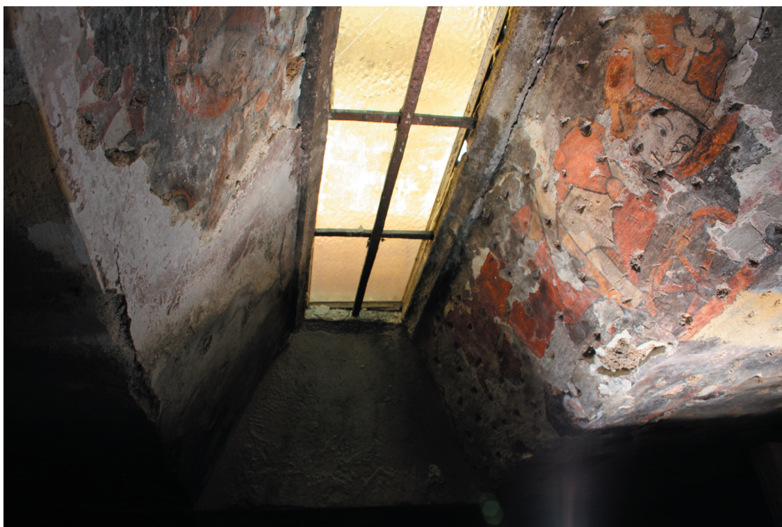
Obr. 8. Pohled na spodní část a bankál okenní špalety. Březen 2010. Foto: M. Třesohlavá.
