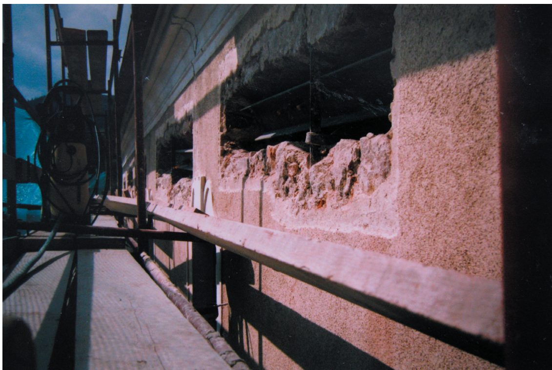
Obr. 6. Exteriér kostela, jižní stěna. Zajišťování statiky budovy. Rok 1997. Reprofoto: L. Bartůňková. Zdroj: Anonym: Chronik der Pfarre St. Martin 1961-2003.
