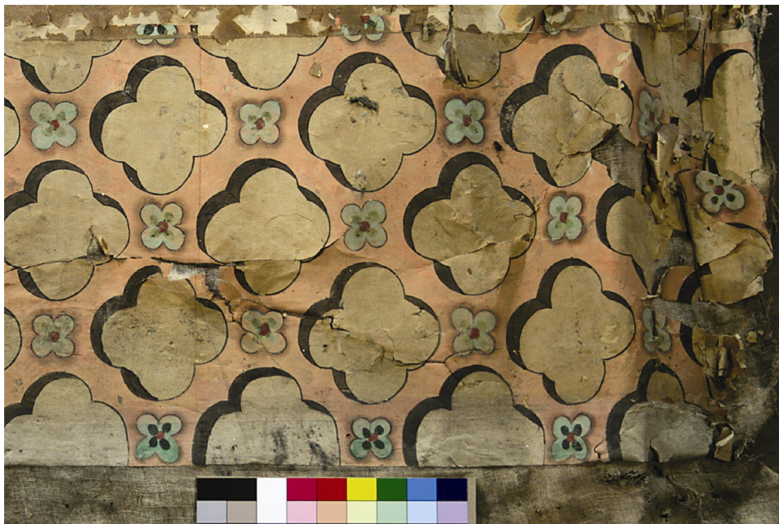
Obr. 52 Část bordury v pravém dolním rohu, stav před restaurováním
