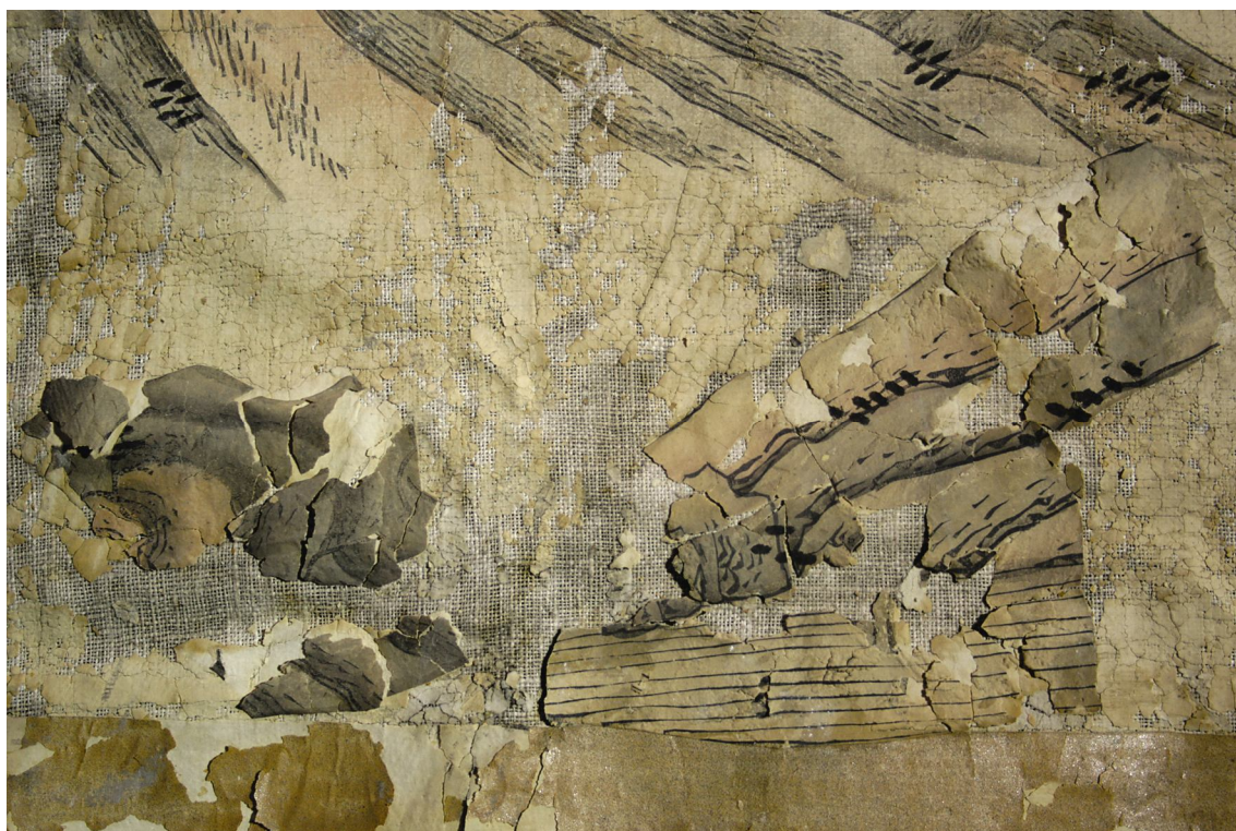
Obr. 49 Detail spodního okraje tapety, stav po srovnání fragmentů a mechanickém očištění
