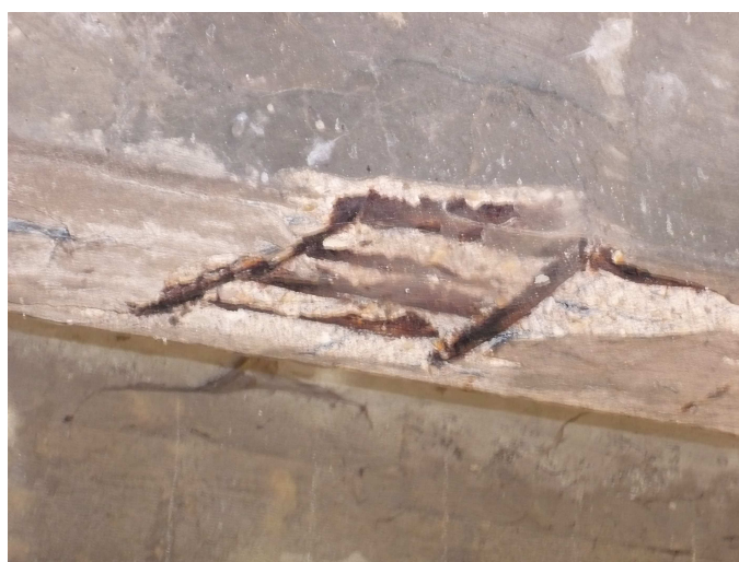
Obr.58 Odloupnutá vrstva výztuže na trámu zespoda mostu
