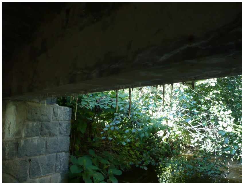
Obr.53 Pohled zespoda na most v Mněticích se zřetelnými znaky degradace
