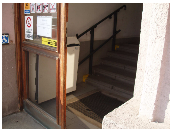
Obr. 57: Pošta - zvedací plošina Zdroj: Autor
