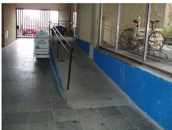
Obr. 39: Bezbariérová rampa MÚ Zdroj: Autor
