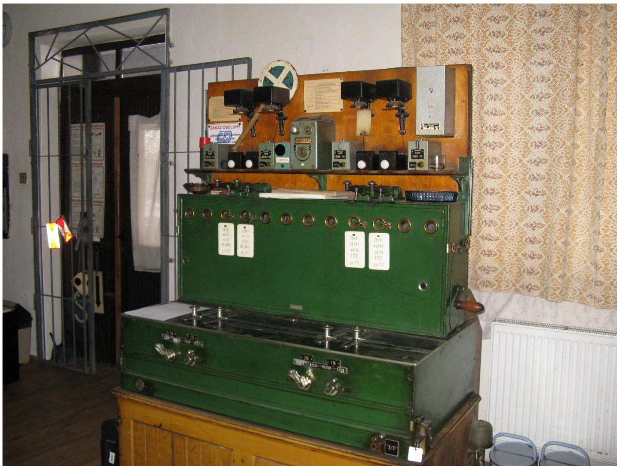
Obr. 1 – Řídící přístroj žst. Liběchov
