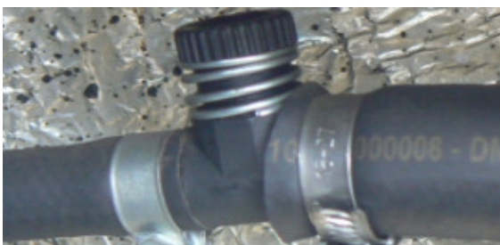
Obr. 13: Nízkotlaké potrubí se škrťícím šroubem
