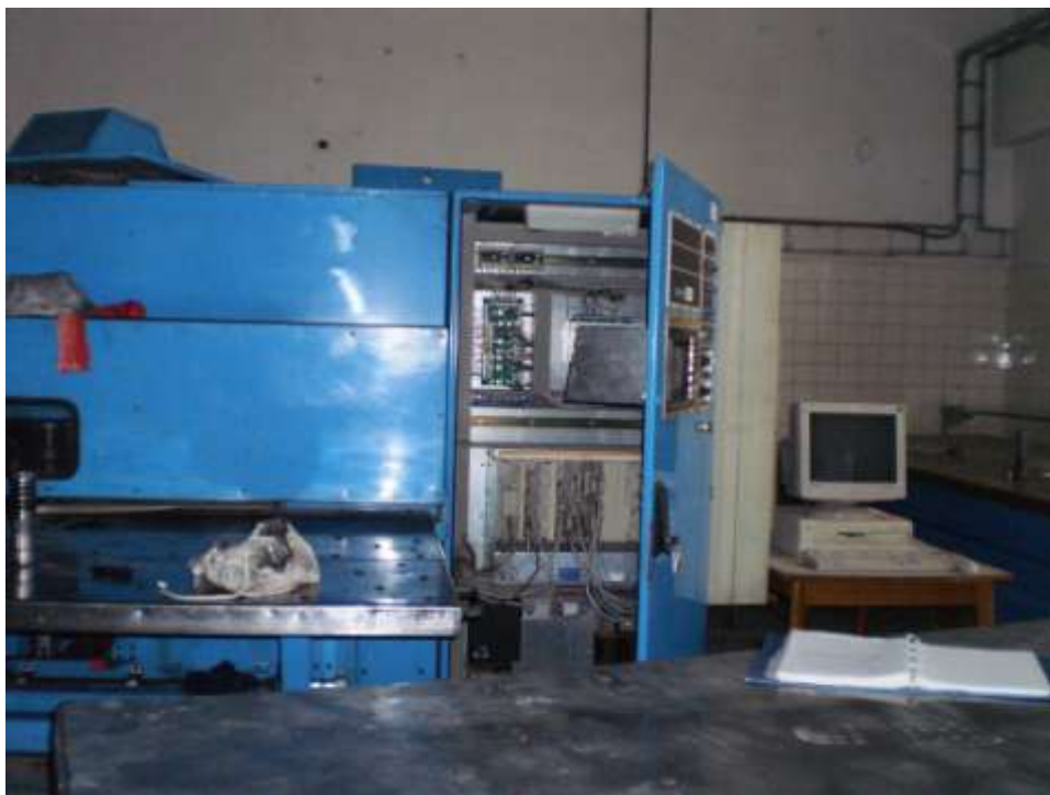
Nález č. 8- otevřený rozvaděč řídicí jednotky stroje- vlastní zpracování
