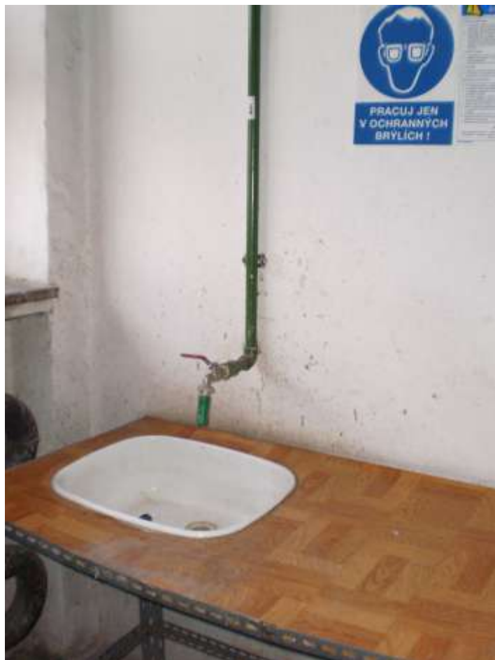
Příležitost ke zlepšení č. 1- kohout vodovodního rozvodu s dřezem- vlastní zpracování
