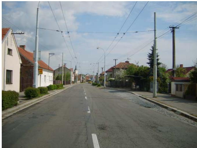
Obrázek 2 – Ulice Šípkova – detail poruch vozovky 2008
