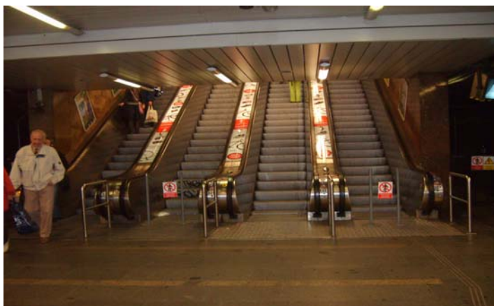
Obrázek č. 15: Eskalátory ve stanici I. P. Pavlova
