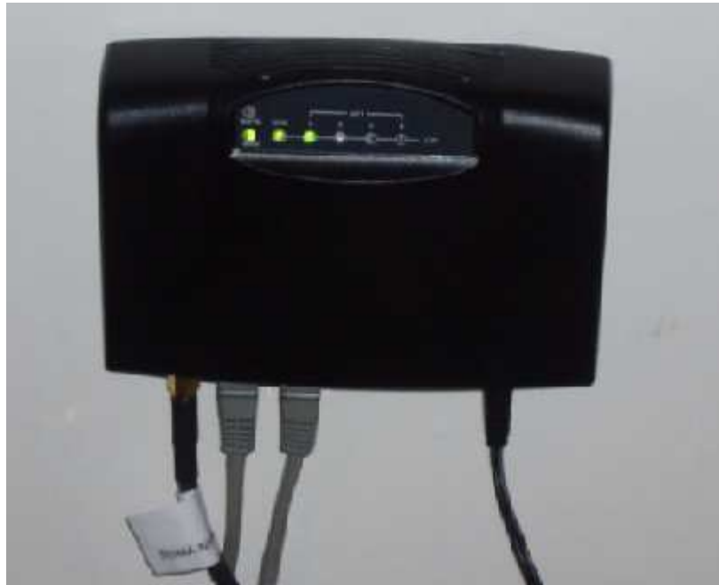
Obr. 30 Namontovaný bezdrátový router
