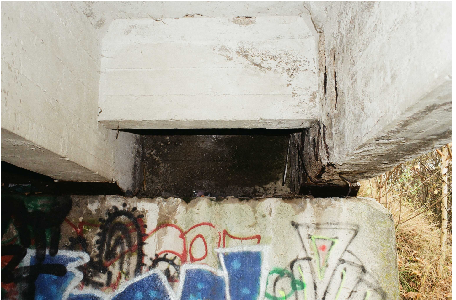
Foto č. 9 - opěra Řečany průsaky vody nosnou konstrukcí pravá část
