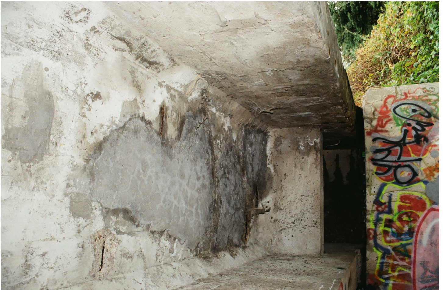
Foto č. 8 - opěra Kladruby průsaky vody nosnou konstrukcí pravá část
