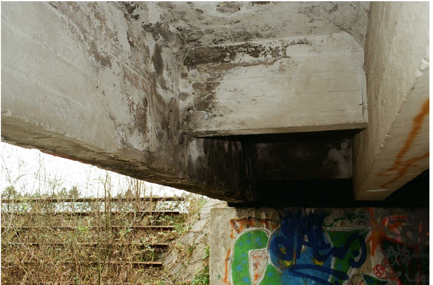
Foto č. 7 - opěra Kladruby průsaky vody nosnou konstrukcí levá část
