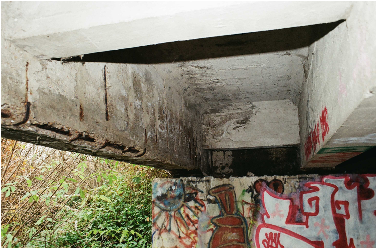
Foto č. 10 - opěra Řečany průsaky vody nosnou konstrukcí levá část
