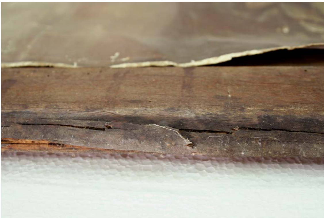
Obr. č. 12 Stav před restaurováním, detail rámu, denní rozptýlené světlo.
