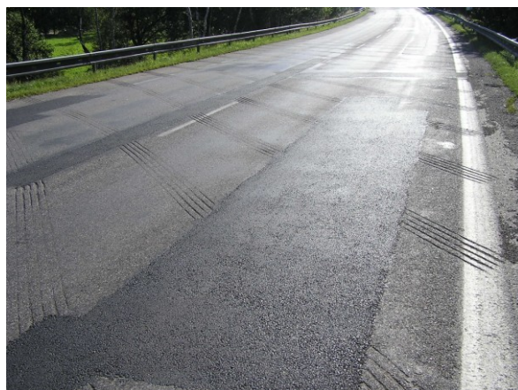
Obr.79 Přerušování drážek lokální opravou vozovky
