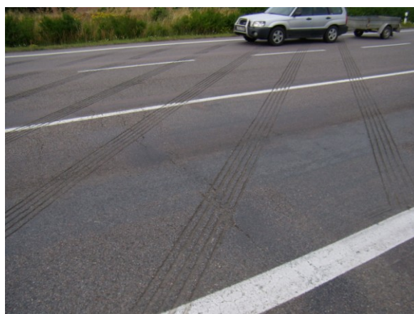
Obr.57. Drážkování provedené na silnici I/35 mezi obcí Hřebeč a Moravská Třebová
