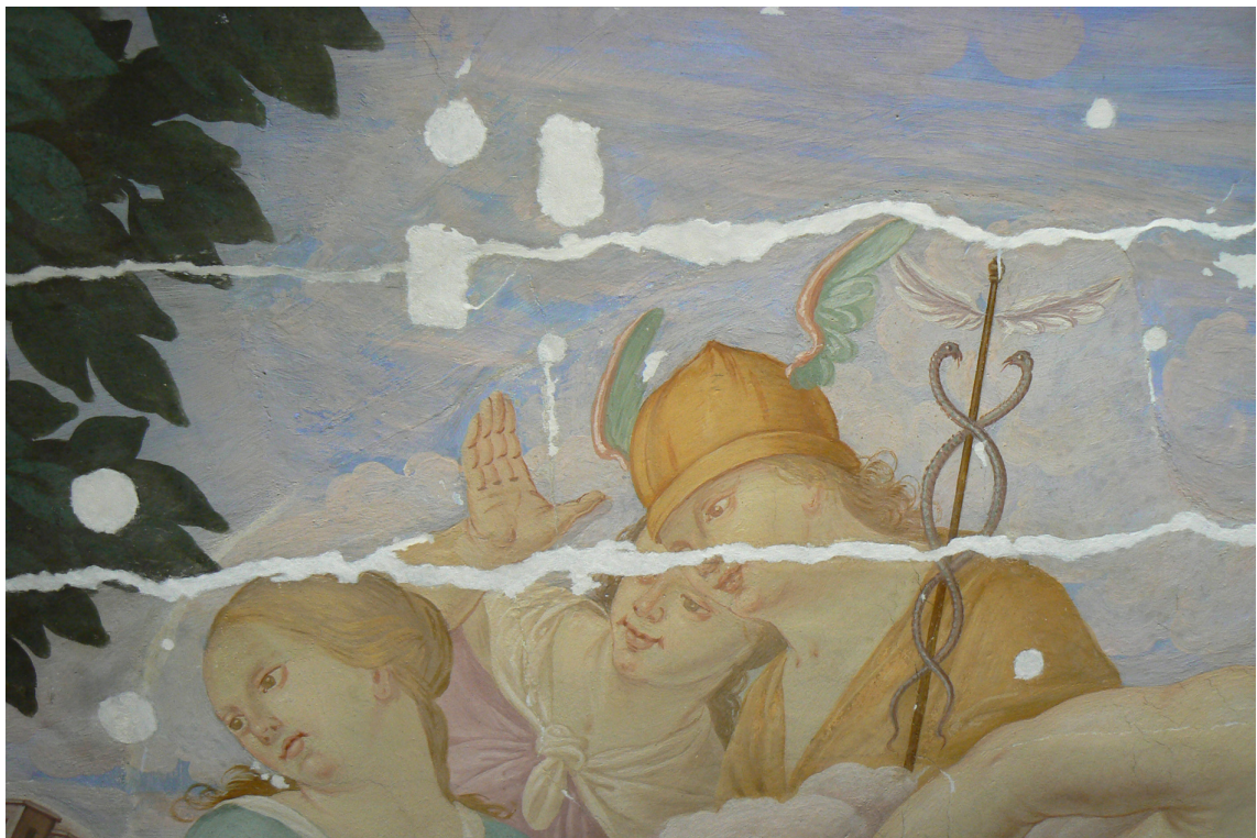
16. Stav po vytmelení.
