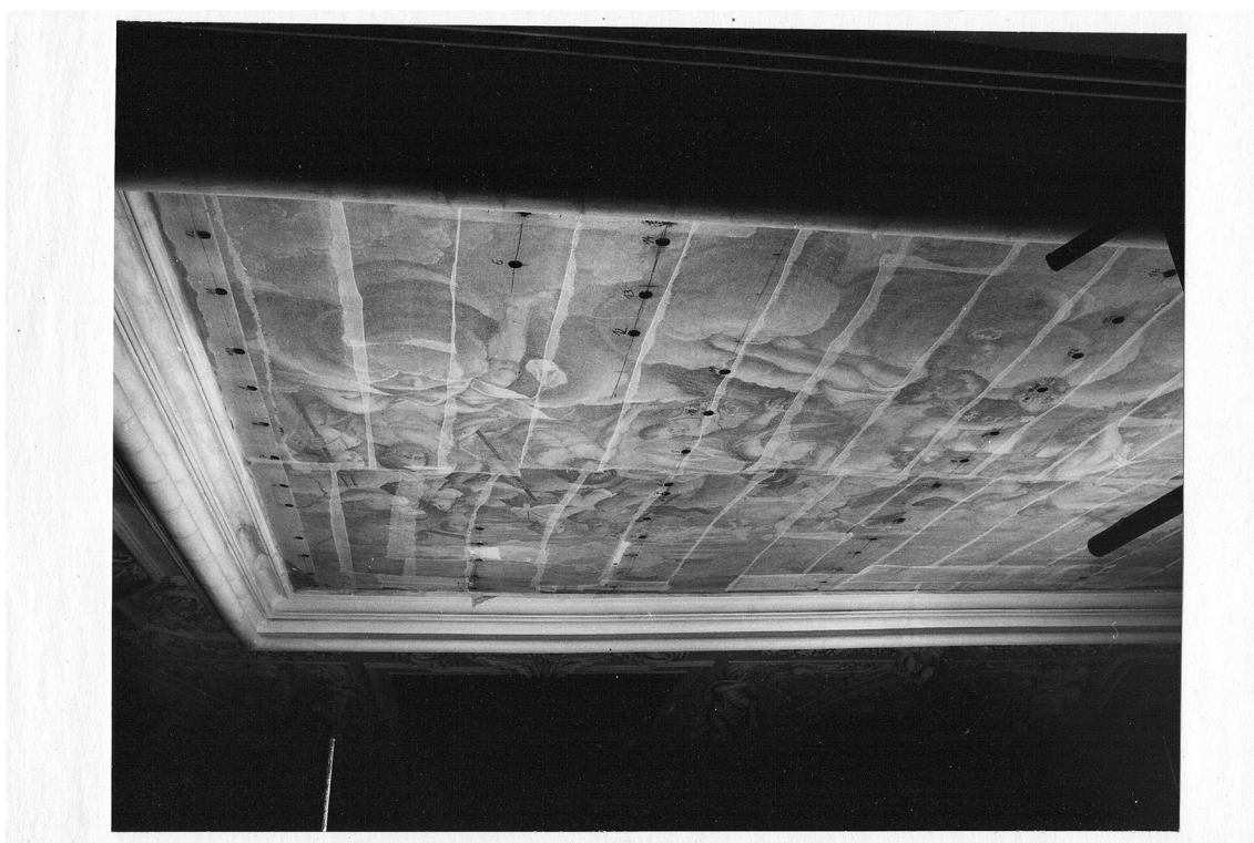
2. Velký sál, severní polovina nástropní zrcadla, zabezpečovací tkaninový přelep, odpreparované otvory k zavěšení fošen podbití.
