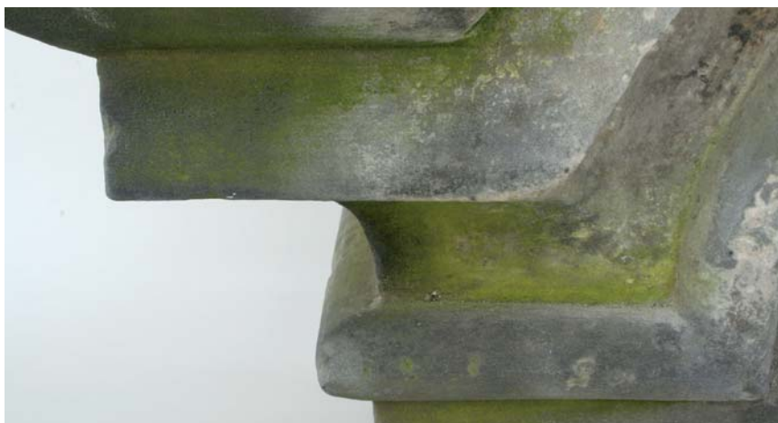
Obr. 68) Stav soklu před restaurováním. Detail biologického napadení mechy.
