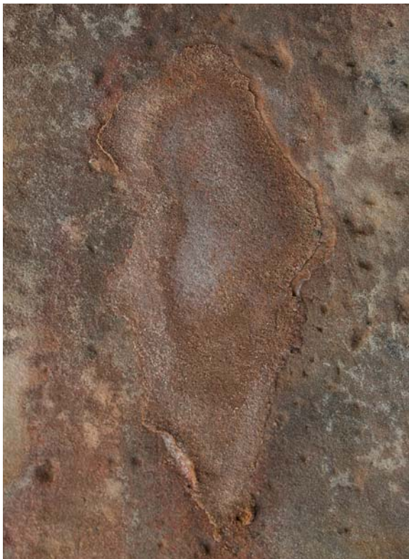
Obr. 77) Stav soklu před restaurováním. Detail staršího tmelu s viditelnými bílými výkvěty solí na povrchu.
