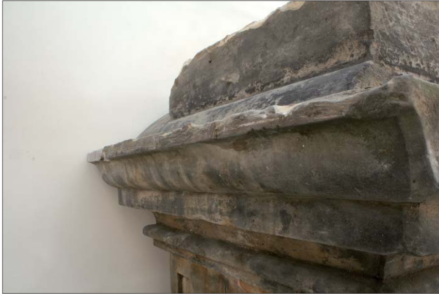
Obr. 82) Stav před restaurováním. Detail poničené římsy.
