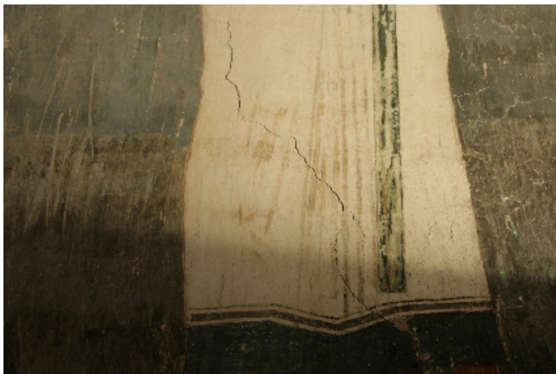
100. Praskliny v omítce na severní stěně obětníka. Detail oděvu jáhna.
