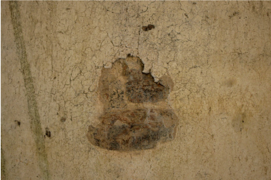
101. Ztráta levkasné vrstvy. Je viditelné cihelné zdivo kostela. Detail na severní stěně obětníku.
