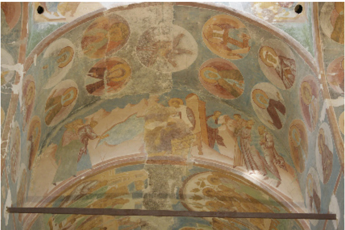
30. Západní podpůrný oblouk. Severní sklon. Obrazy mučedníků a spravedlivých žen s kříži v jejich rukou. V zúžené lunetě západního oblouku - kompozice "Učení Jana Zlatoústého" (církevní otec). Jsou dobře viditelné tmely z 18. století s barevnou úpravou na nich.
