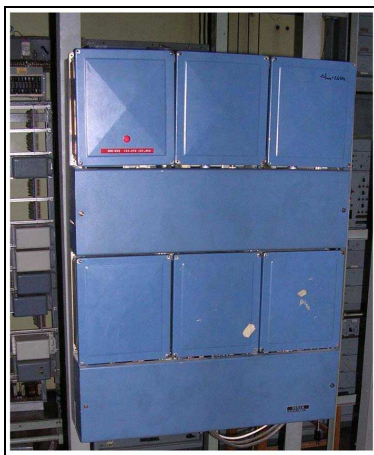
Obr. 3-2: Základnové radiostanice MRS v pásmu 150 MHz v ŽST České Velenice [autor]
