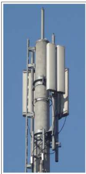
Obr. 3-5: Stožár s anténami systému GSM-R v ŽST Praha – Hlavní nádraží [autor]
