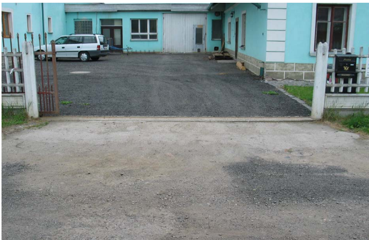
OBYTNÁ ZÓNA – úsek “B” vjezd na pozemk.parcelu č. 25, cca 60 m od z.ú. “B”
