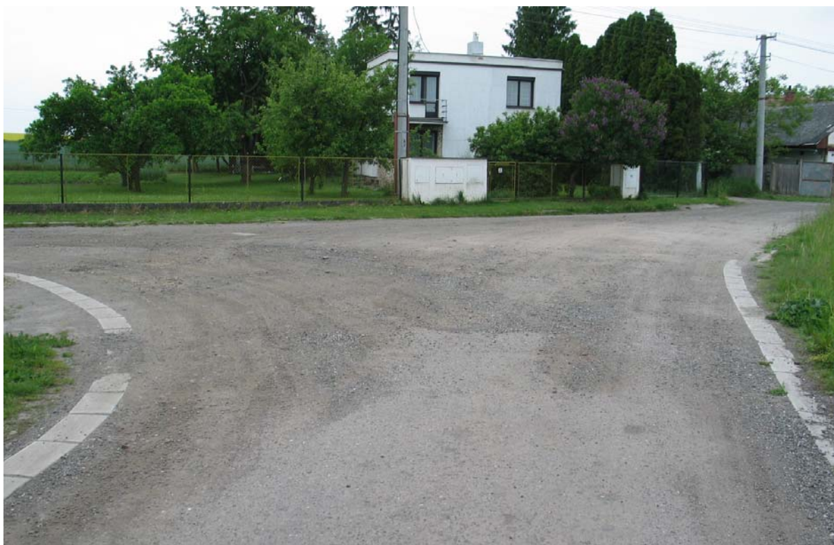
ÚROVNĚOVÁ KŘÍŽOVATKA – úsek “A“ pohled na místo křížení úseků “A“ a “B“, cca 115 m od z.ú. “A“
