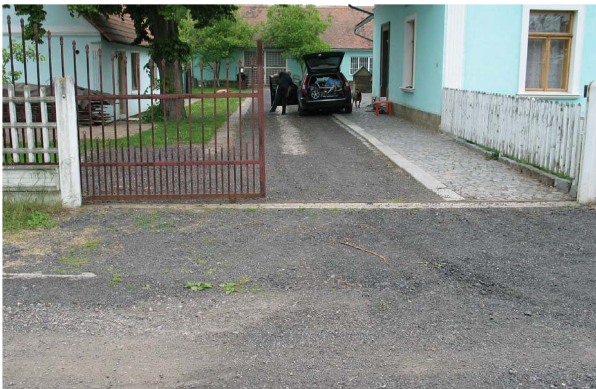
OBYTNÁ ZÓNA – úsek “B“ vjezd na pozemk.parcelu č. 26, cca 40 m od z.ú. “B“
