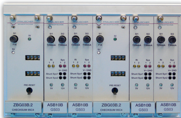
Obrázek 35: Vnitřní část počítače náprav AZF v konfiguraci pro sledování dvou kolejových úseků
