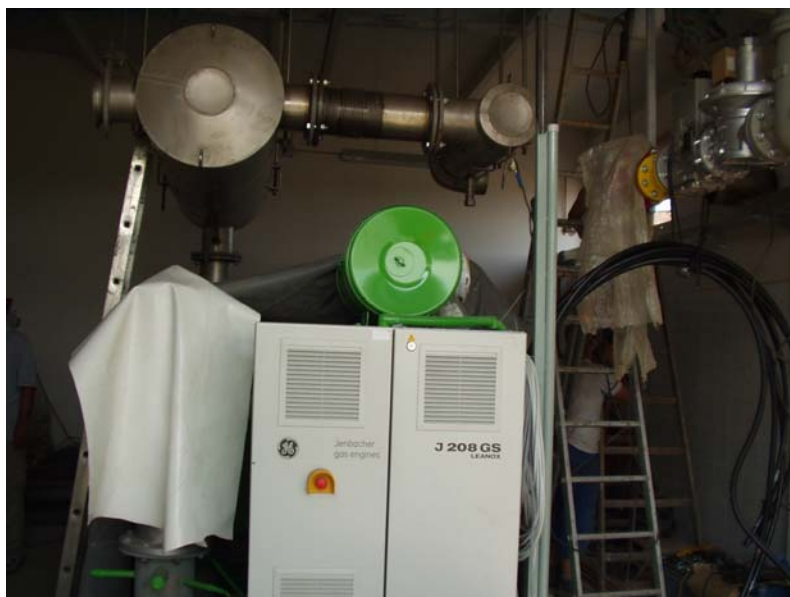
Obrázek 10: Kogenerační jednotka , zdroj: Autor
