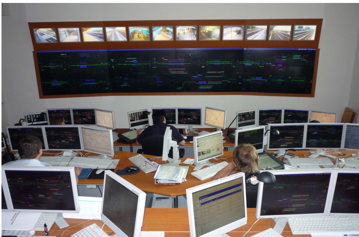
Obrázek 4: Řídicí sál tratě Přerov – Břeclav na CDP v Přerově.
