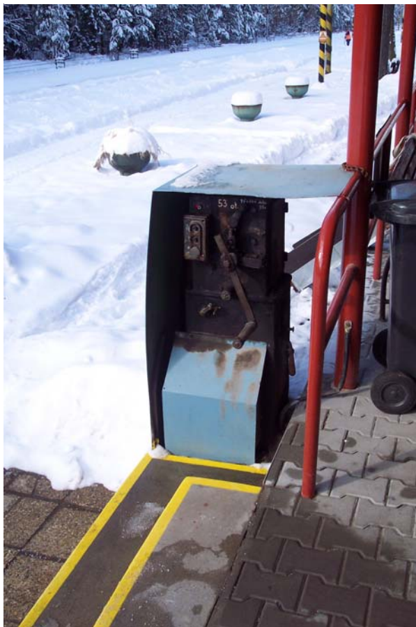
Obrázek 22 - Mechanické zabezpečovací zařízení - přejezd
