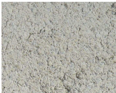
Zkouška č. 9, stav po přesečení
