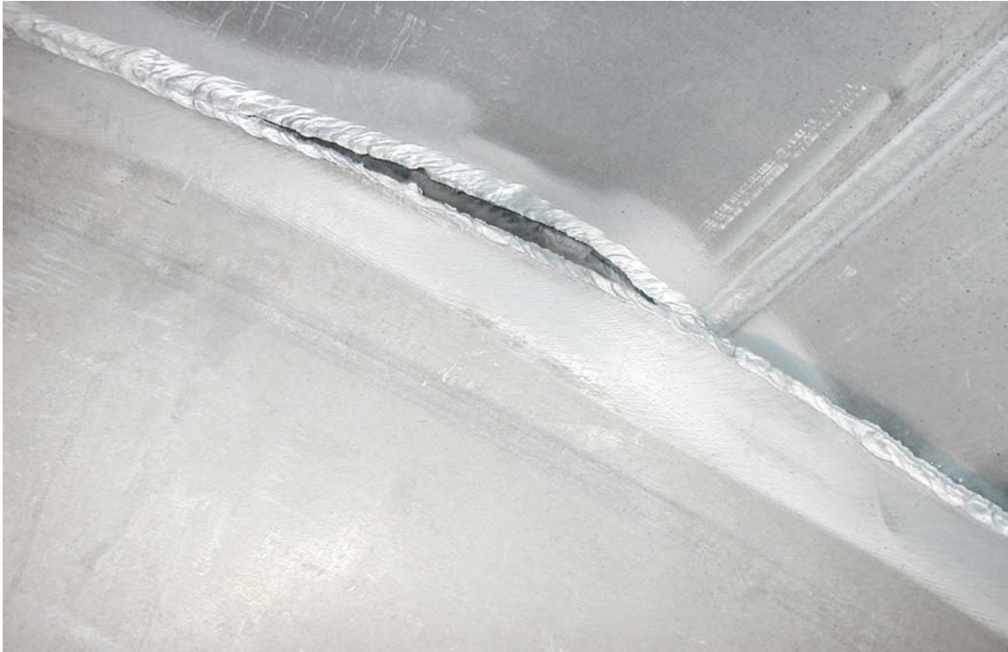
Obrázek 5 Ukázka poddymenzovaného svaru na havarované cisterně
