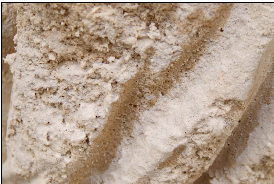
Obrázek 31: Směs K/B. Detail povrchu poškozeného odformováním se vznikajícími výkvěty.
