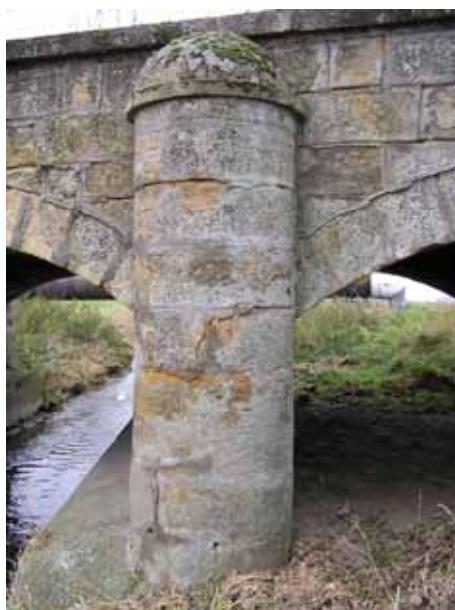
Číslo obrázku : 3 , Pohled na přední část pravého pilíře na straně vtoku Popis poruch: Uvolněné bloky pískovcového zdiva , chybějící výplň spar , ve střední části prasklý kamenný blok opěry.
