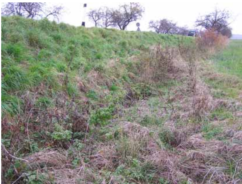
Číslo obrázku : 12 , Zemní těleso v přechodové oblasti mostu Popis poruch: Nezpevněný příkop je zarostlý vegetací
