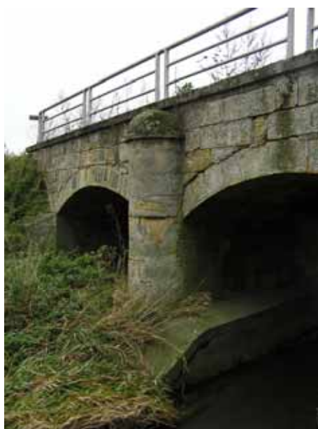
Číslo obrázku : 4 , Pohled na přední část levého pilíře na straně vtoku Popis poruch: Uvolněné bloky pískovcového zdiva , chybějící výplň spar , ve střední části prasklý kamenný blok opěry. Posun parapetních zídek ven z konstrukce
