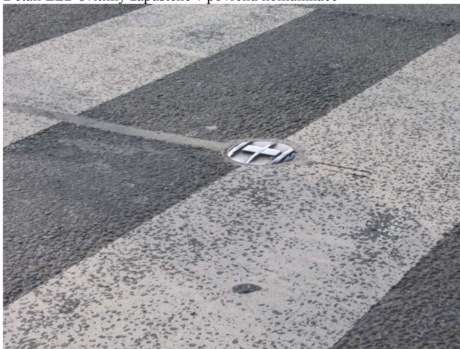
Obr. 12 – Detail LED svítilny zapuštěné v povrchu komunikace
