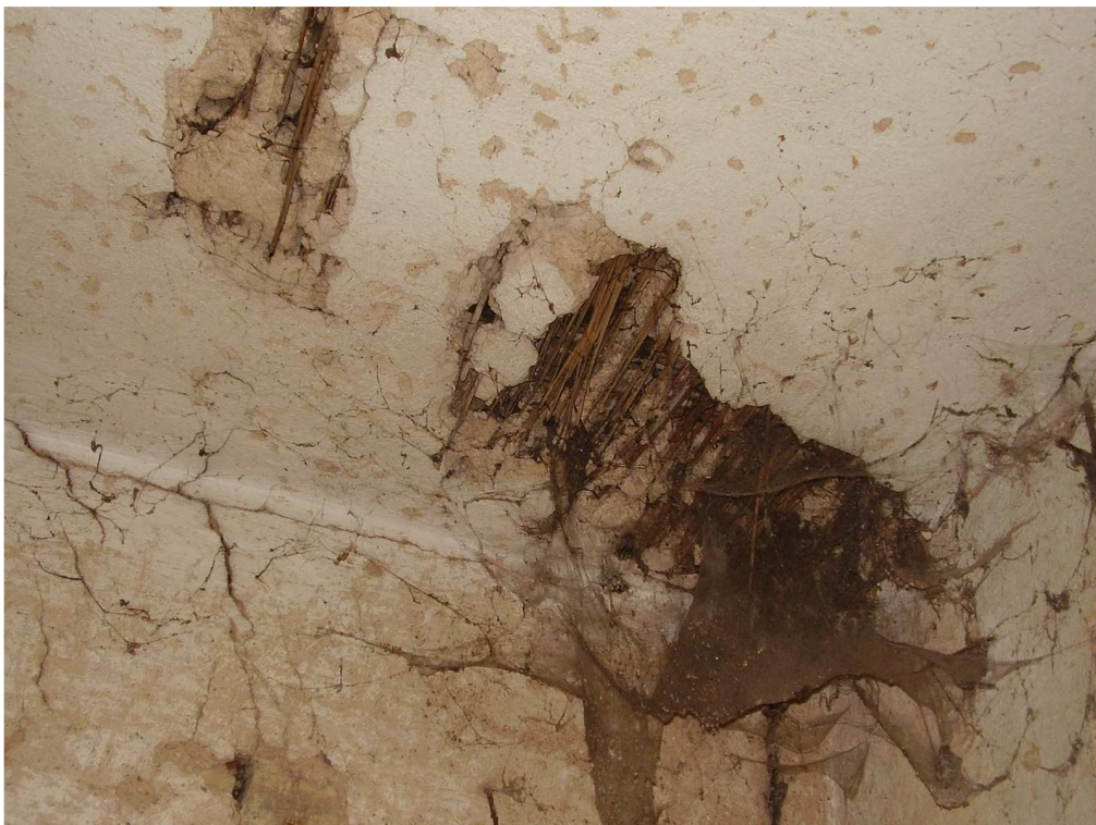
Obr. 71 - Destrukce podhledového omítaného stropu s rákosovým rastrem v prostoru bývalé márnice v severním věžním přístavku.
