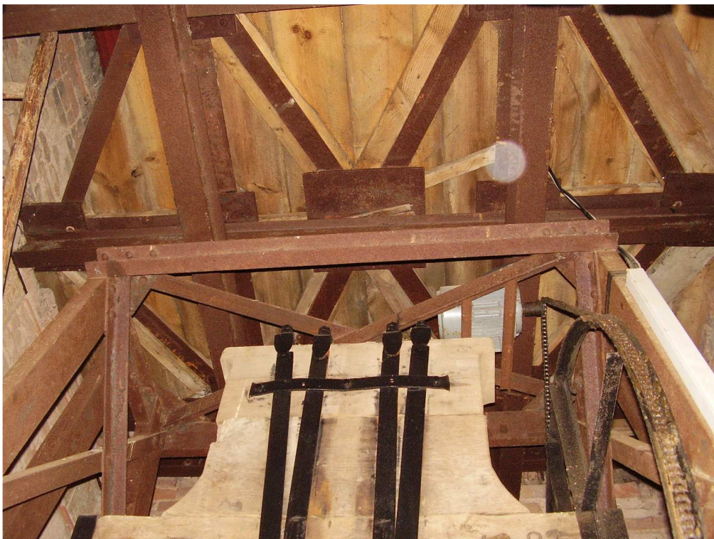
Obr. 67 - Pohled na traverzový strop zvonového patra a horní část spodní zvonové stolice.
