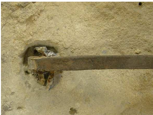
Obr. 23 stav před restaurováním - rezavé až tmavě hnědé skvrny na povrchu kamene po vysychavých olejích
