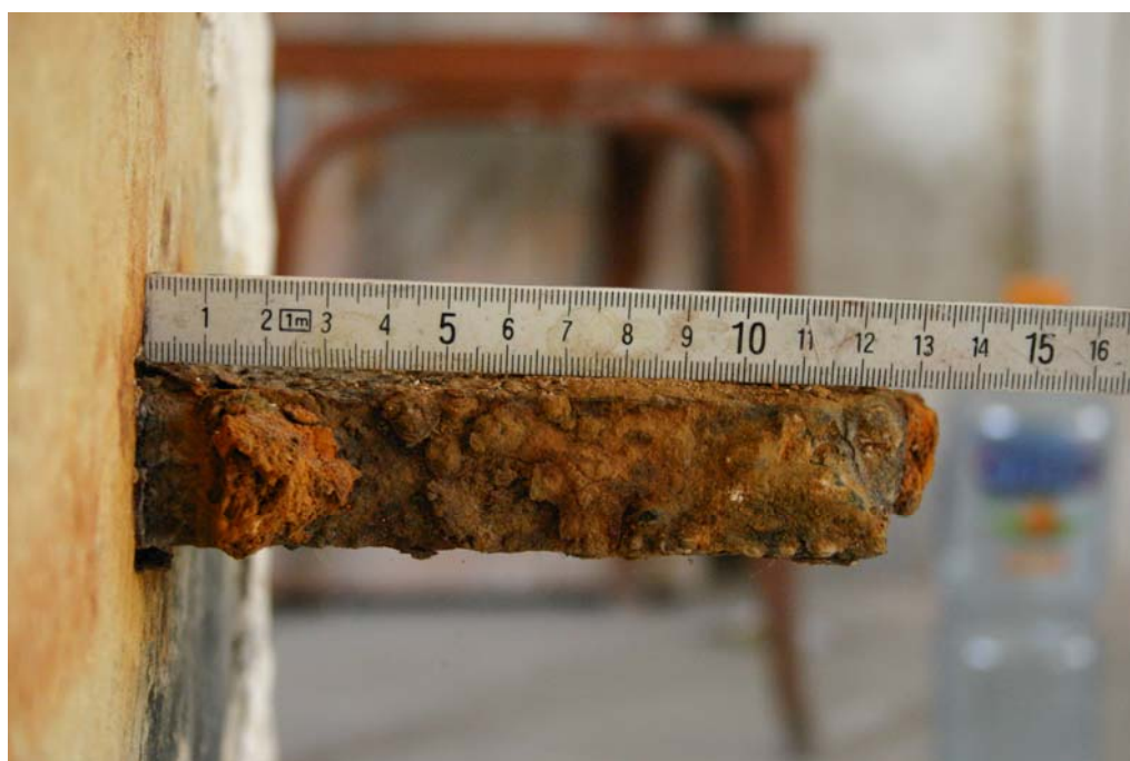
Obr. 7 Korodující čep, detail.
