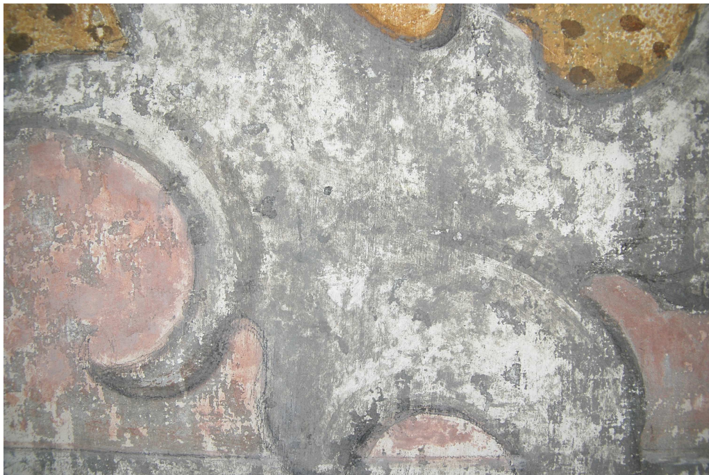
Obr. 2 Po čištění vodou (dolní oblast rámu) – zbytky přemaléb
