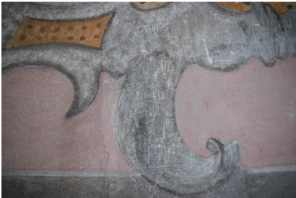
Obr. 29 Nedestruktivní průzkum v rozptýleném světle - mechanicky poškozený originál
