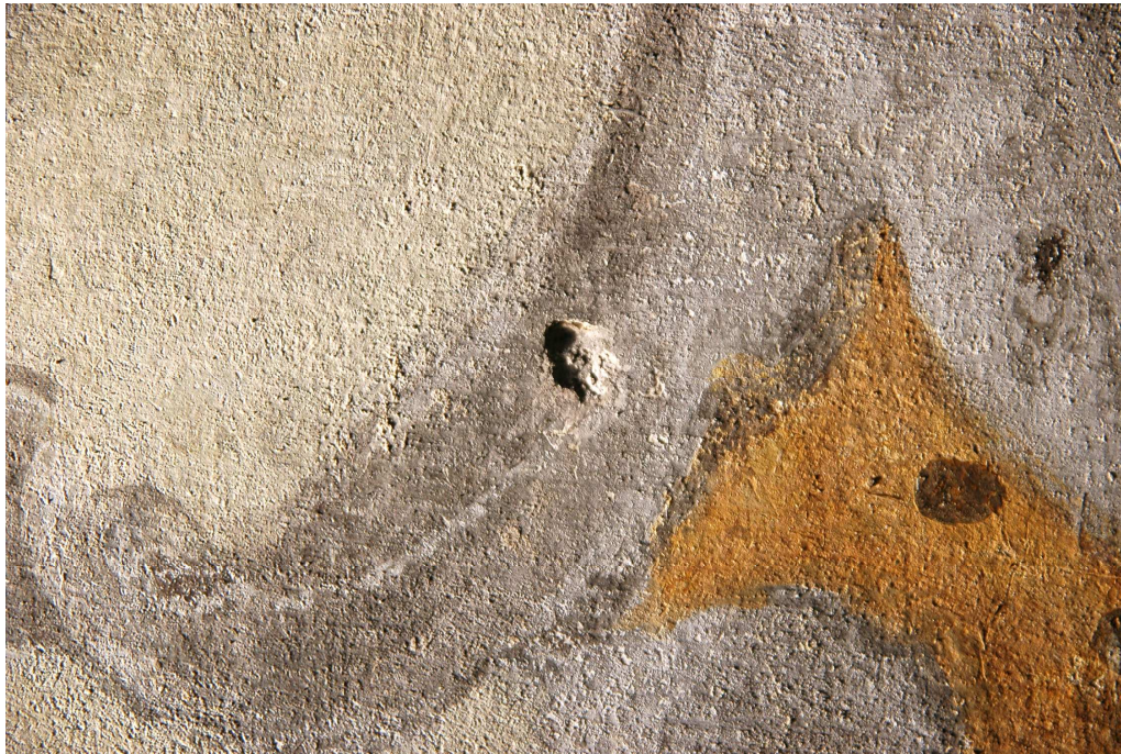
Obr. 36 Nedestruktivní průzkum v razantním bočním osvětlení (rokokový rám), mechanická poškození (díry)
