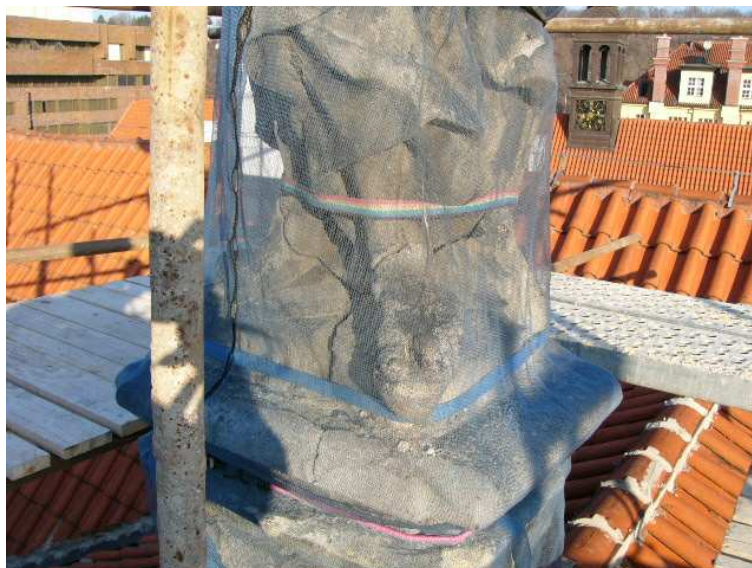
Obr.14. Nejsvětější Salvátor , demontáž, stav před restaurováním na místě
