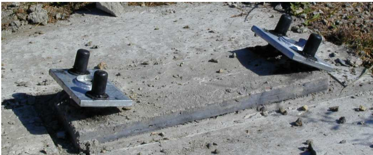
Obrázek č. 8 Deformace příhradové konstrukce v patní desce – svarový lom
