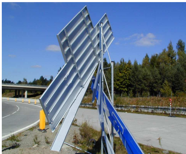
Obrázek č. 10 Deformace příhradové konstrukce
