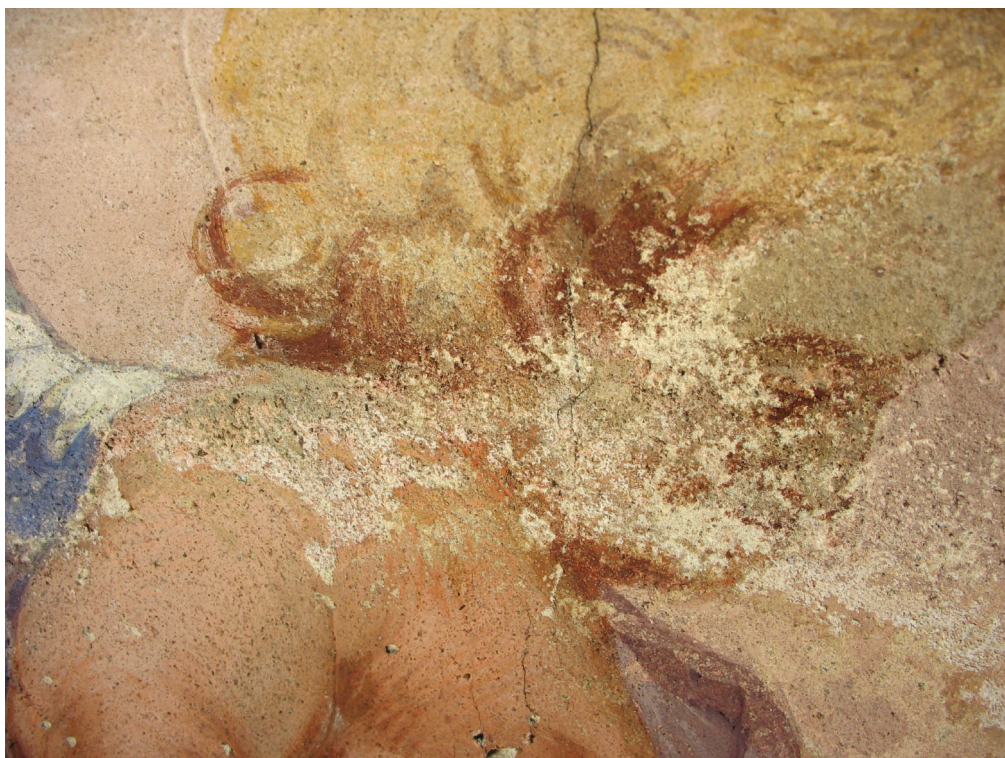
Obr. 17 Obličej anděla poškozený solemi.
