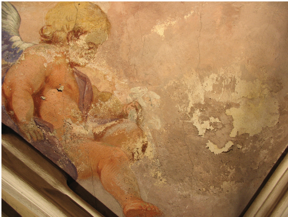
Obr. 16 Soli způsobují též zpráškovatění a puchýřkovitou strukturu odpadávající barevné vrstvy malby
