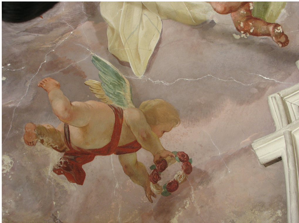
Obr. 47 Detail vytmelené trhliny.
