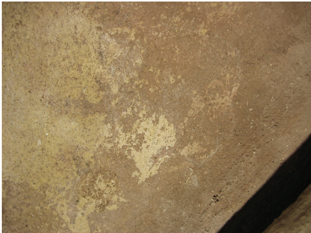
Obr. 44 Stav po obkladu; na místě jsou patrné jemné bílé zákaly.
