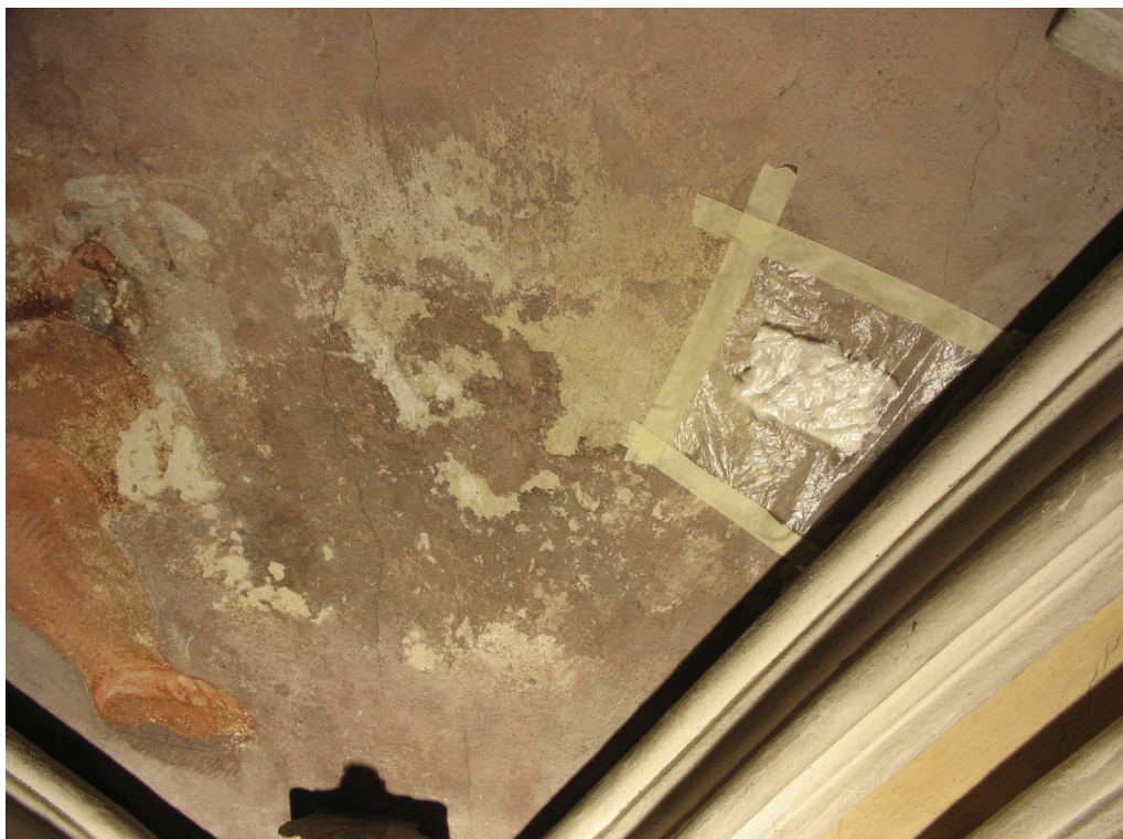
Obr. 42 Zkouška stabilizace solí pomocí obkladu \text{Ba}(\text{OH})_2
