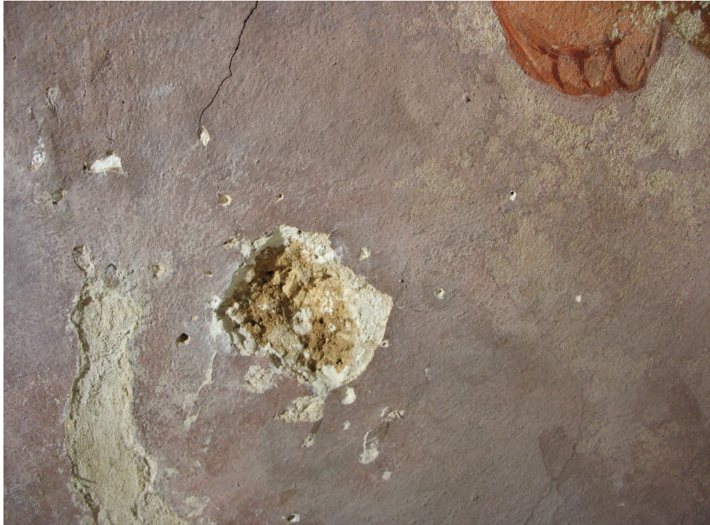
Obr. 48 Stav před tmelením
