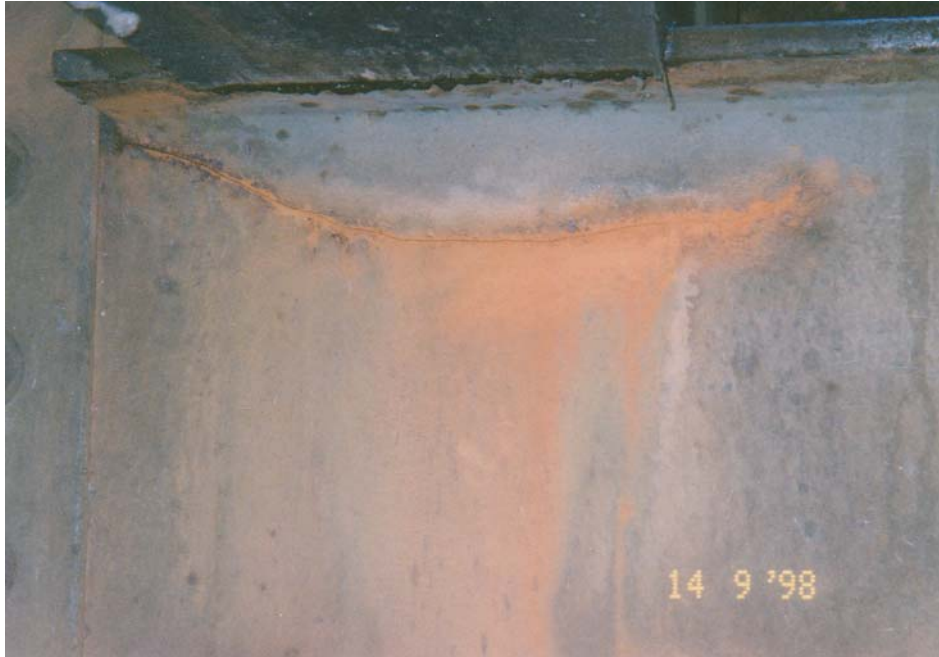
Obr.7.4. Únavová trhlina – pohled č.2.
