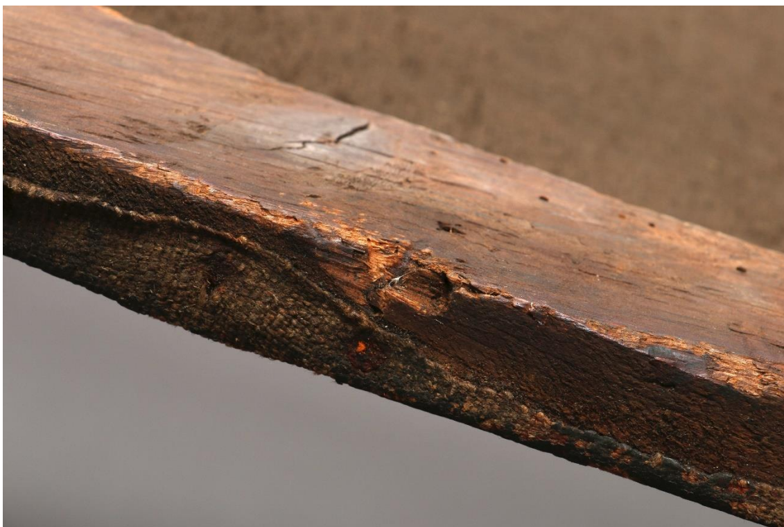
Obr. 34, Stav před restaurováním, detail zkorodovaných hřebíků
