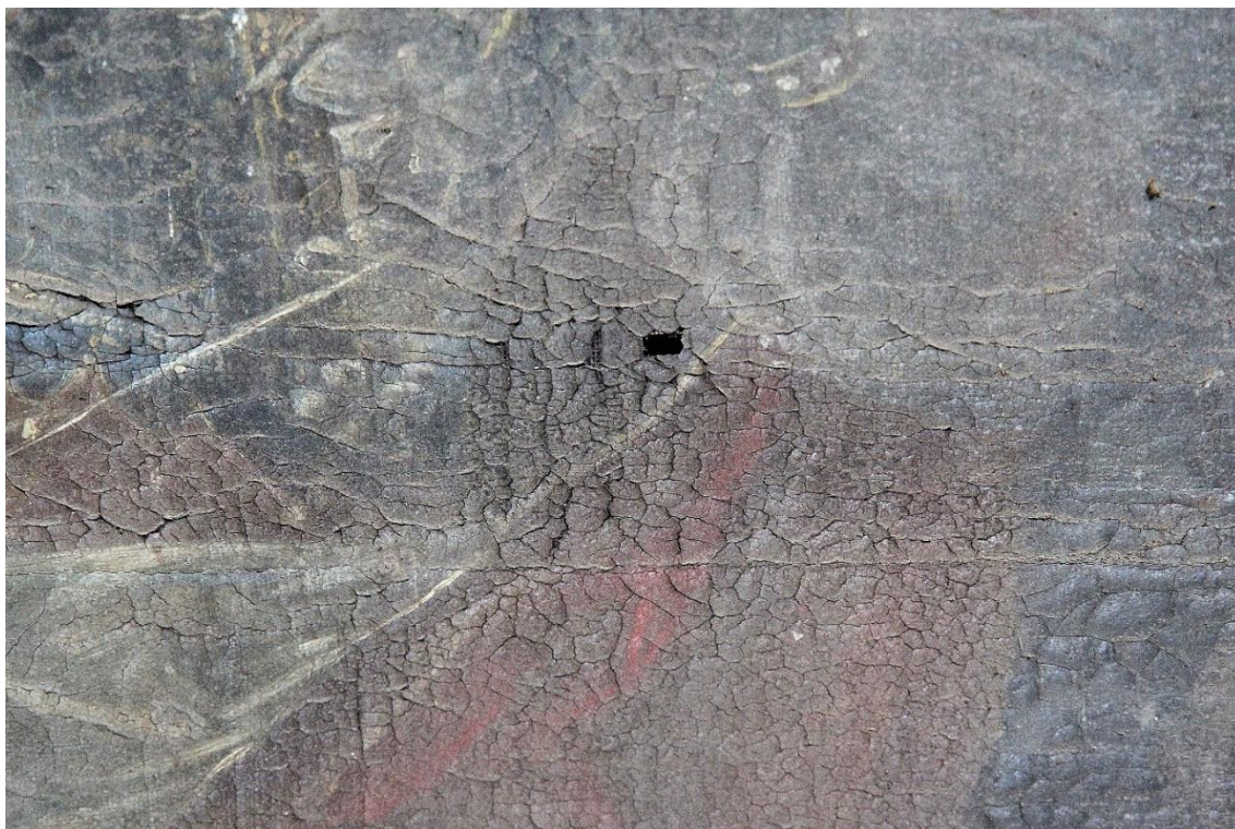
Obr. 5543 F. J. Lux, Sv. Tekla, kostel Nanebevzetí Panny Marie, Seč u Blovic, detail poškození barevné vrstvy a perforace plátna
