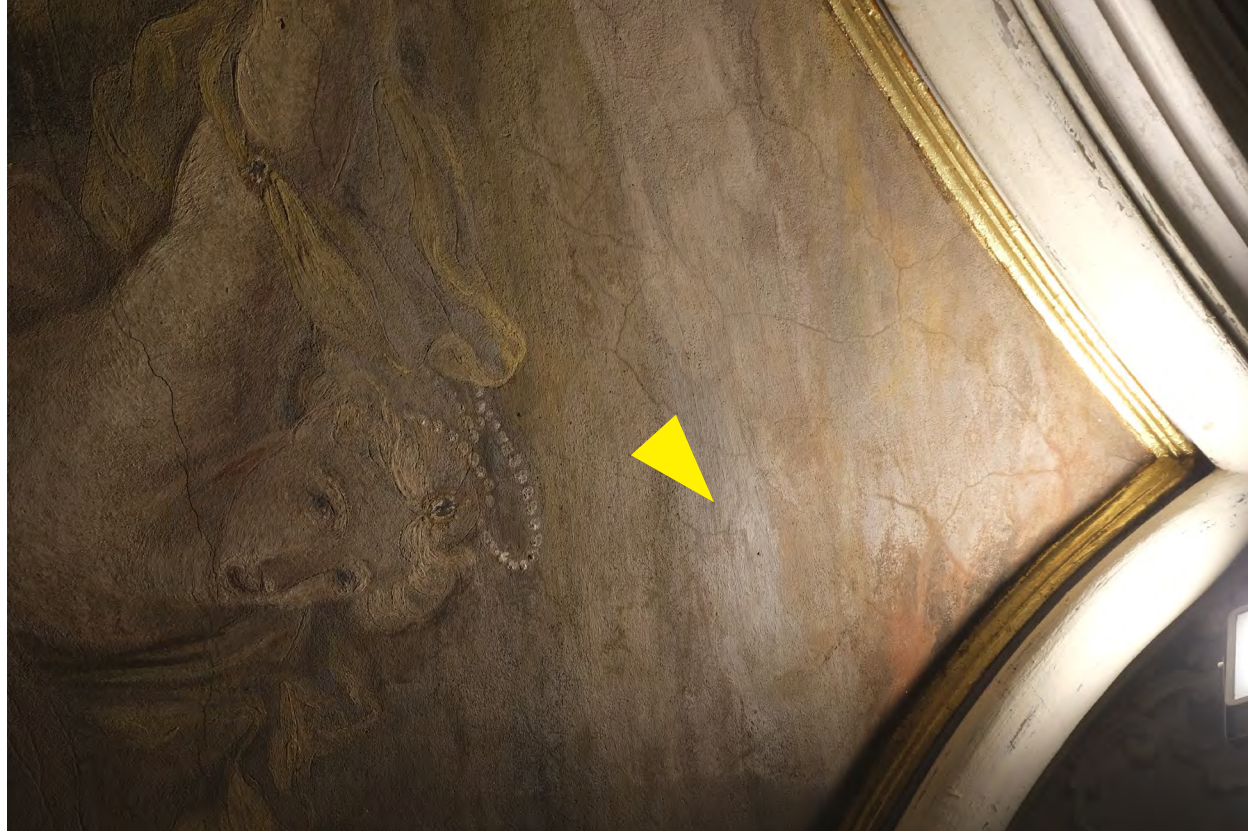
Obr. 21: Detail lesklé části pod hlavou postavy. Prostopášnost, označeno šipkou. Stav před restaurováním.
