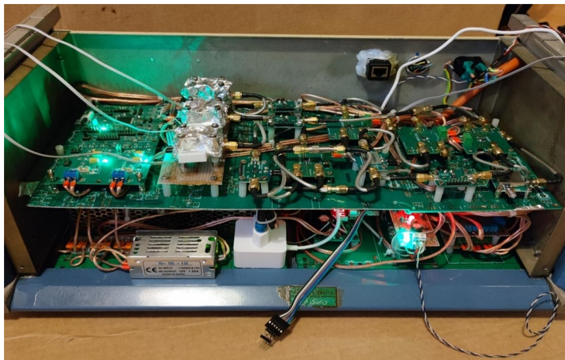
Obrázek 7.6: Náhled na smontovanou část krabice obsahující zdroj a přijímací část – přední pohled. (Zdroj: Vlastní.)
